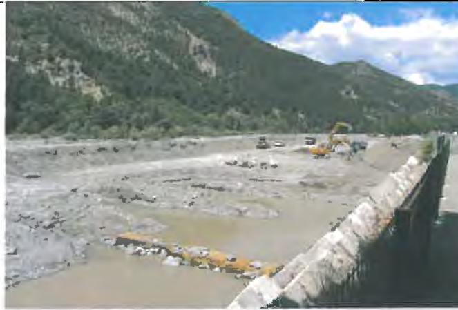
Exemple de bassin mis en place lors des travaux de confortement de la digue des Epinettes amont à Digne les Bains en 2013 (photo SMAB)
