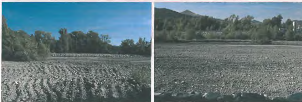
Lit de la Bléone remis en état suite au chantier de confortement de berge au lieu-dit Valadier à Digne (SMAB, 2012)
