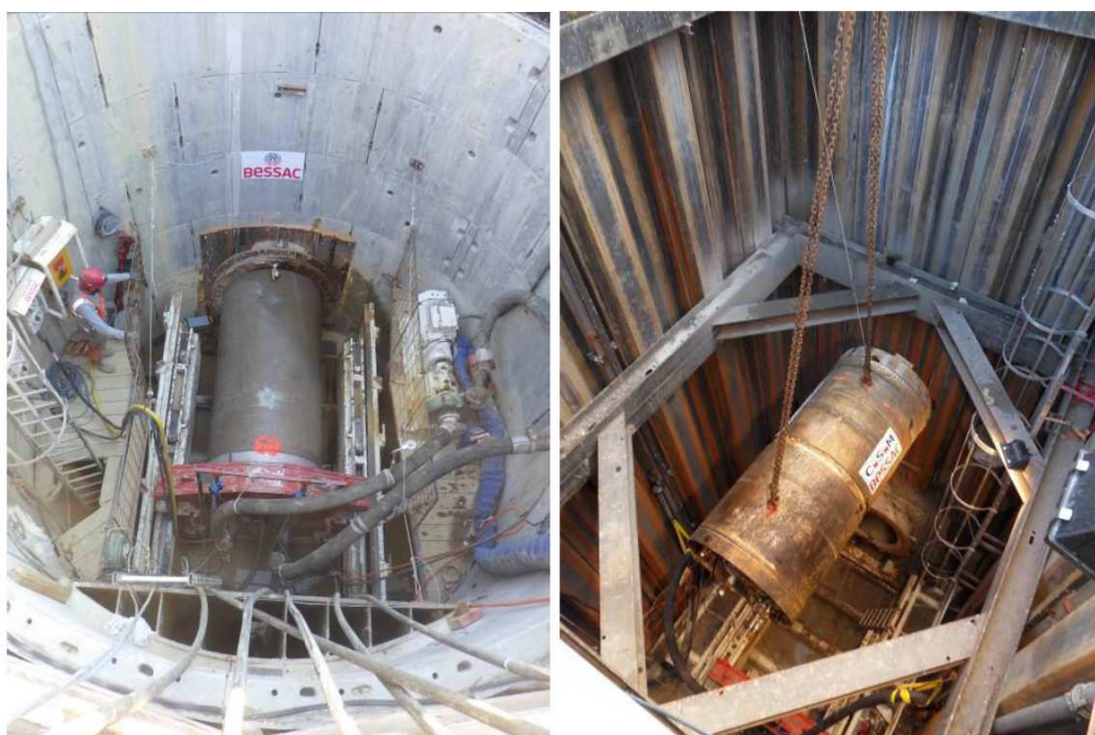
Figure 45 : Exemple de chambres de tir : puits en béton armé ou en palplanches acier (source : BESSAC)
