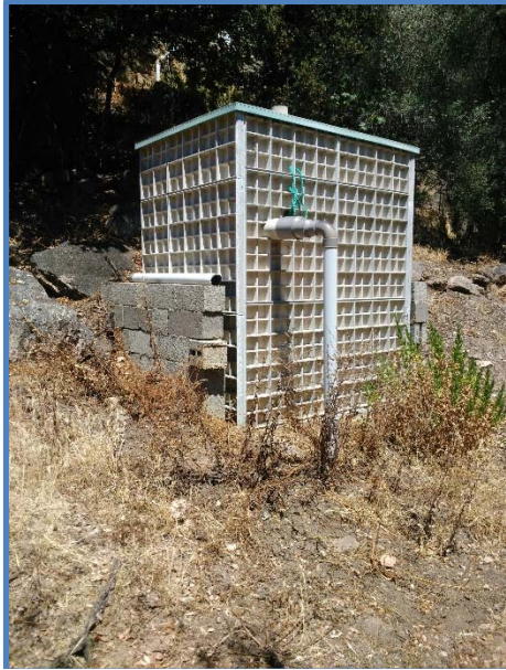
Figure 8 : Micro station d'épuration de l'auberge d'Acciola
