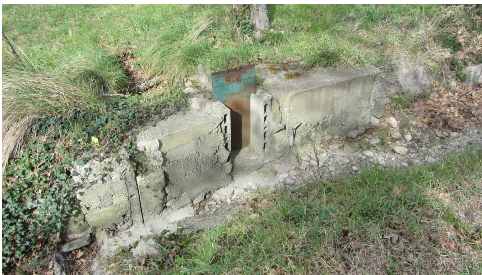
Martelière permettant l'irrigation d'un jardin à partir du réseau de l'ASP du canal de Craponne à Istres – quartier des Craux à Istres – mars 2016
