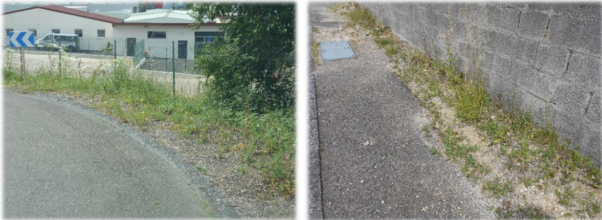
Figure 15: revêtement des trottoirs très abimés, propice au développement végétal – ZA de la Motte.
