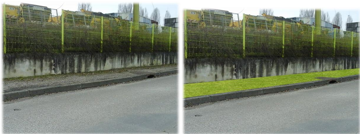
Figure 17: Enherbement des trottoirs au revêtement très abimé.
