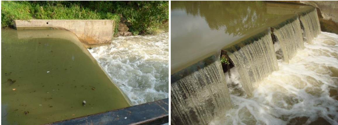
Fig. 7. Clapet à supprimer
