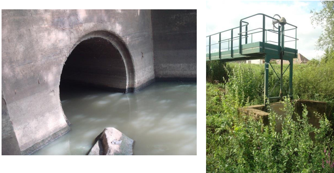
Fig. 17. Vannage et buse sur la partie aval du bief de l'anneau
