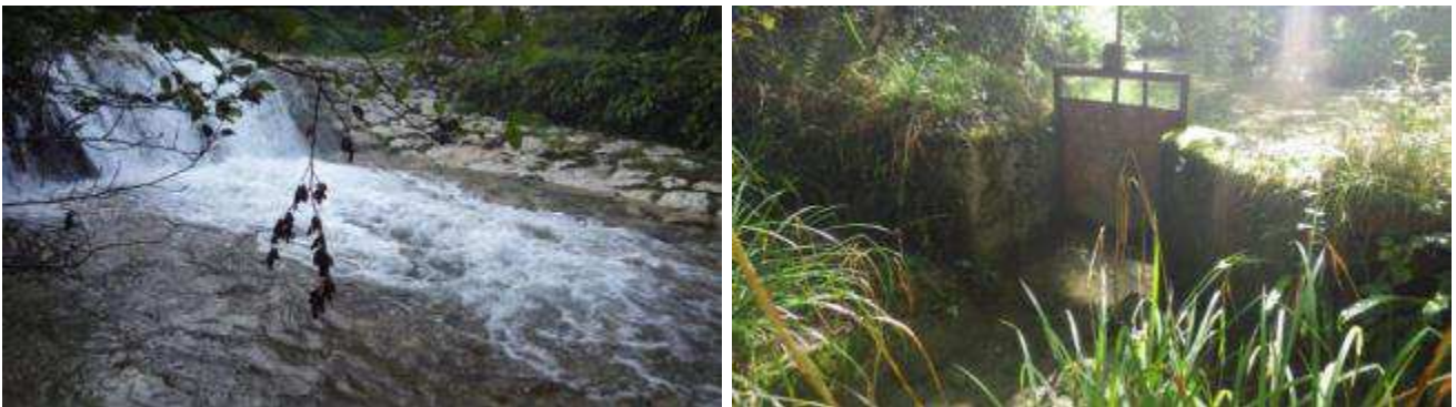
Figure 20 : Seuil de stabilisation en aval de le RD921 (ROE34146) et vanne d'alimentation des 2 lacs privés (ROE34087)
