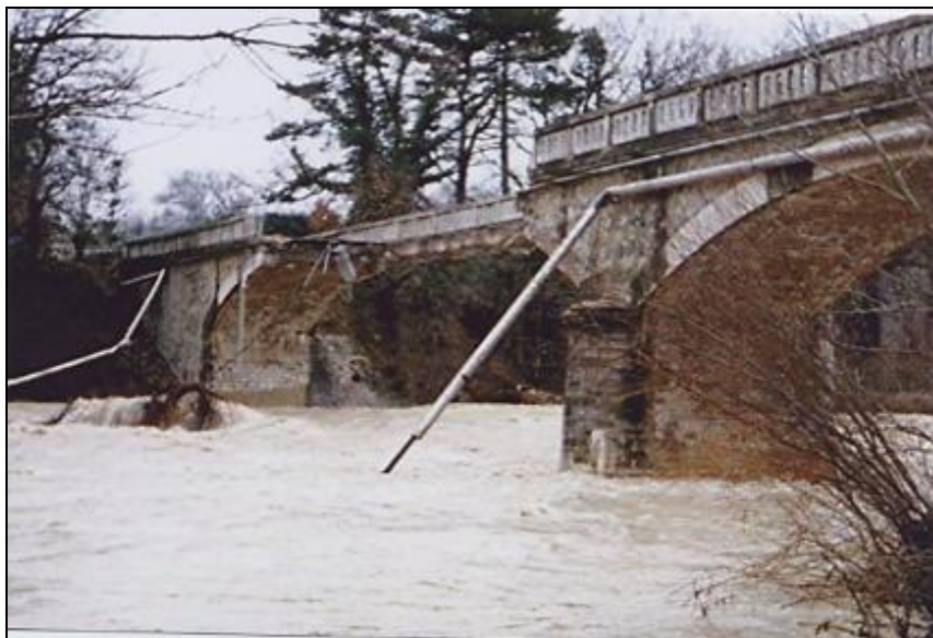
Photo 1 : Pont du Batelier à la suite de la crue du 7 janvier 1994 - Source : Mairie de Piégros-la-Clastre
