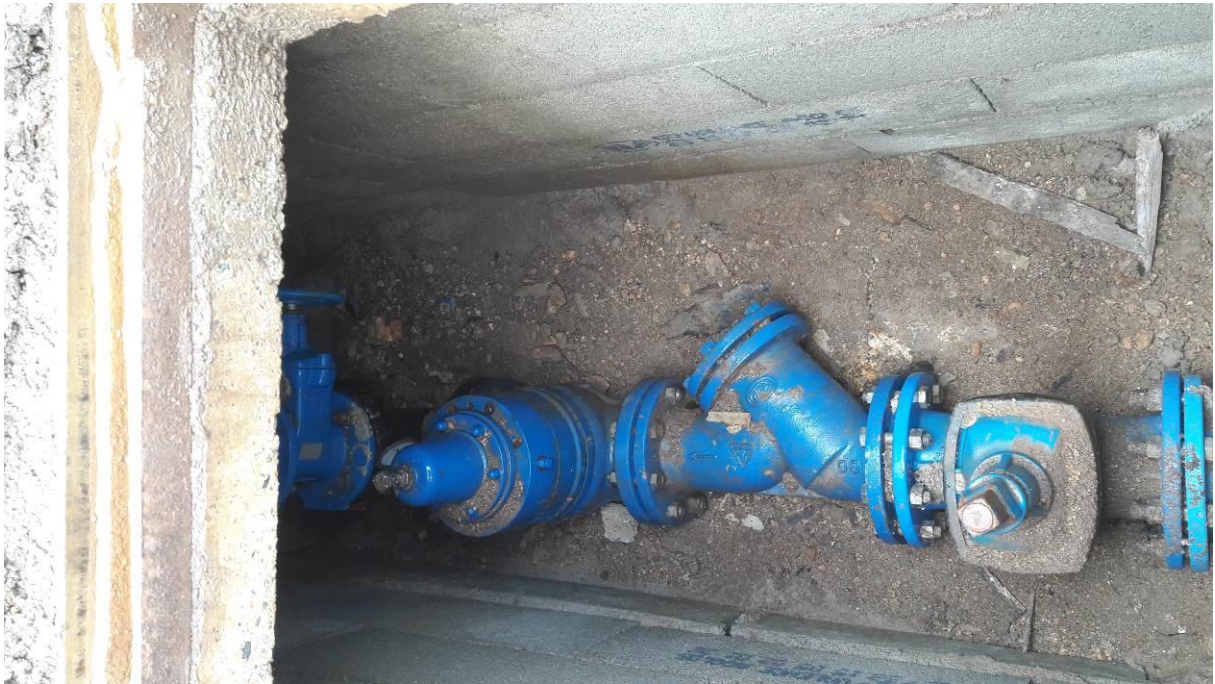
Photo du réducteur de Pression RP9 – Aval Réservoir de la Grange
