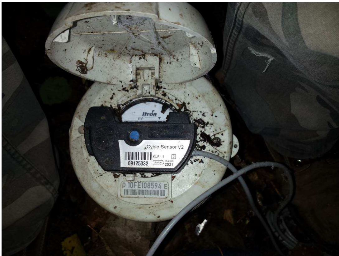
Photo du Compteur C9 – Distribution d’eau en sortie du réservoir des Vernées
