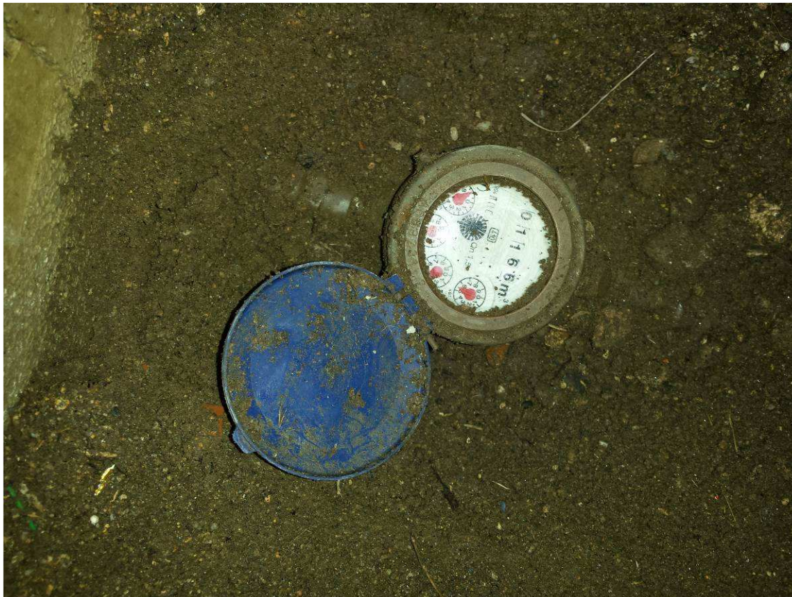
Photo du Compteur C6 – Distribution d'eau vers les vestiaires du stade
