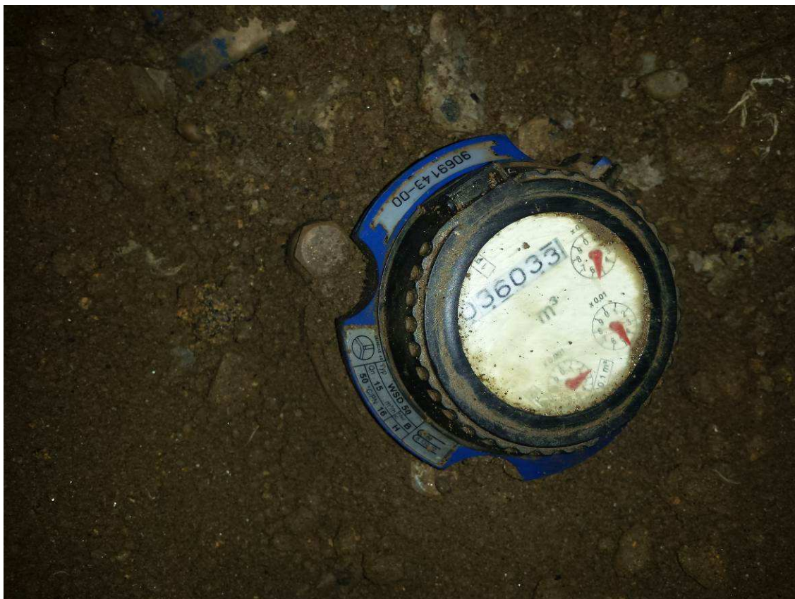
Photo du Compteur C7 – Distribution d'eau vers le stade de football
