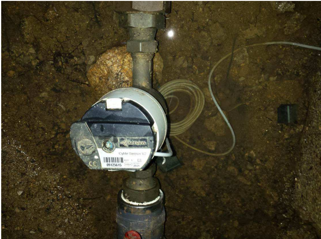
Photo du Compteur C11 – Distribution d'eau en sortie du réservoir du Sablas
