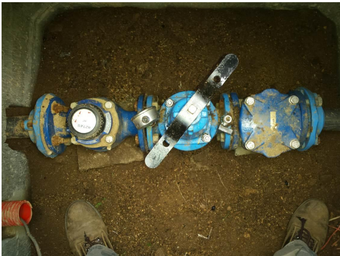
Photo du réducteur de Pression RP1 – Réservoir du village
