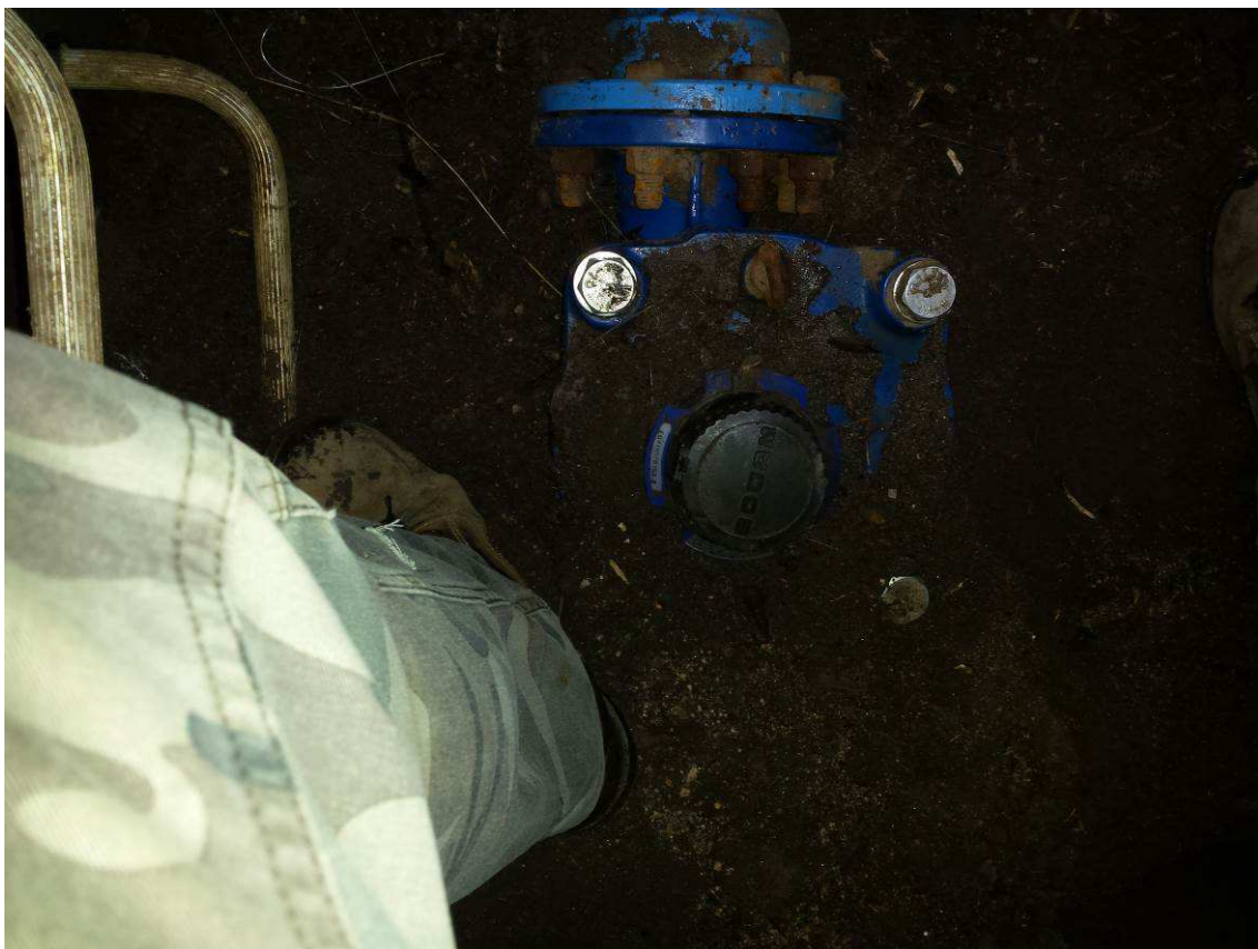
Photo du Compteur C1 – Distribution d'eau en sortie du réservoir du Crau
