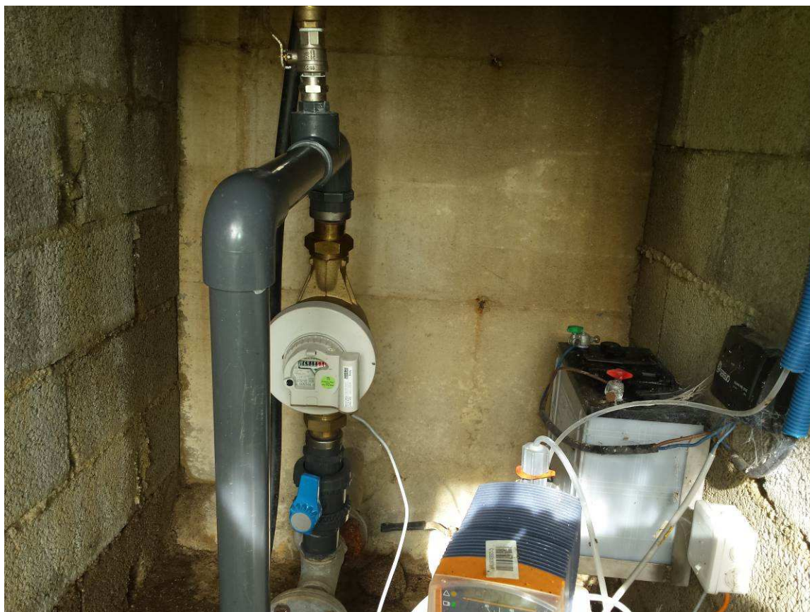
Photo du Compteur C8 – Distribution d'eau en sortie du réservoir du Chier
