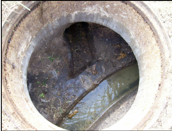
Regard de bypass du 1 er bassin
