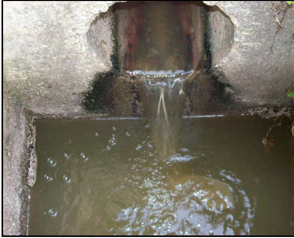
Arrivée eaux usées en entrée de la STEP
