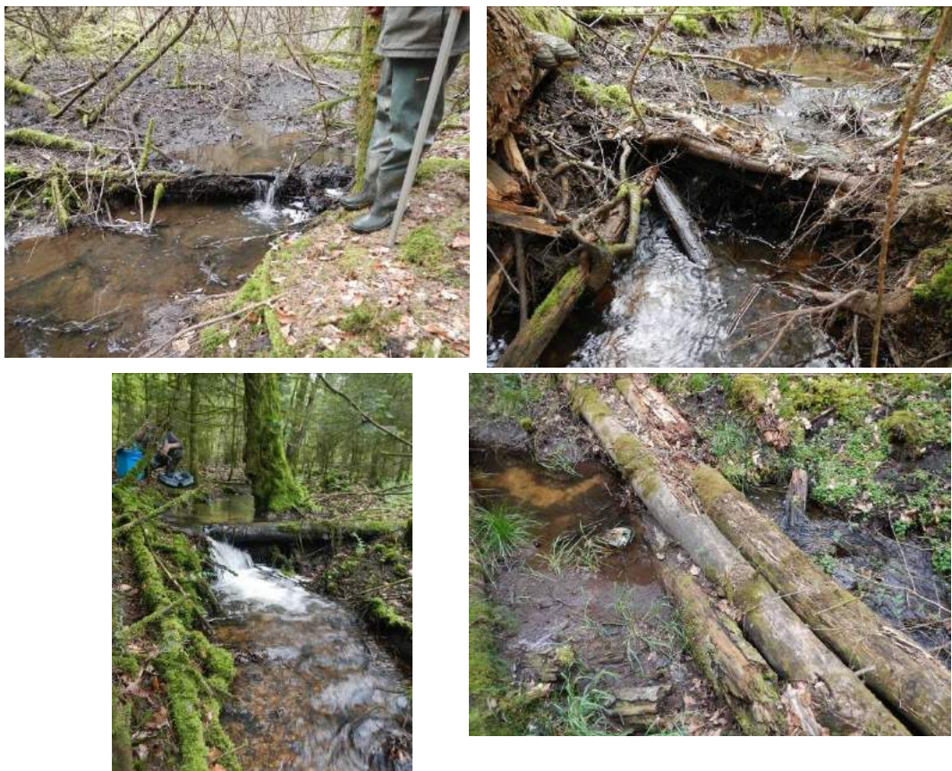
Photographie 12 : embâcles formant des obstacles, tronçon aval étang en haut, ruisseau des Oeillets en bas à gauche, tronçon aval confluence en bas à droite.
