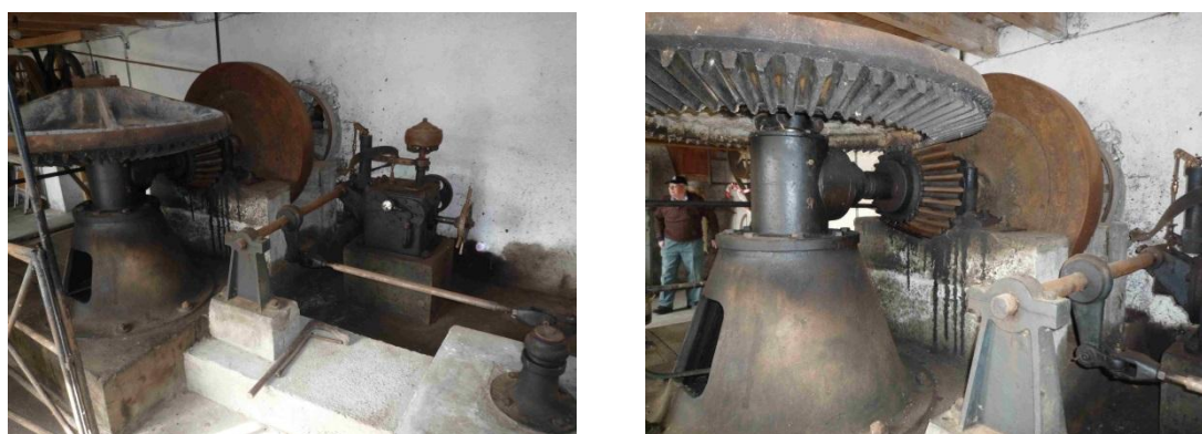
Turbine et régulateur des vannes.
