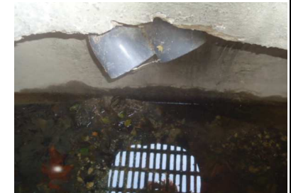
Trop plein vers le réseau pluvial
