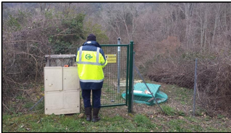
Photo 1 : Vue d'ensemble du poste
