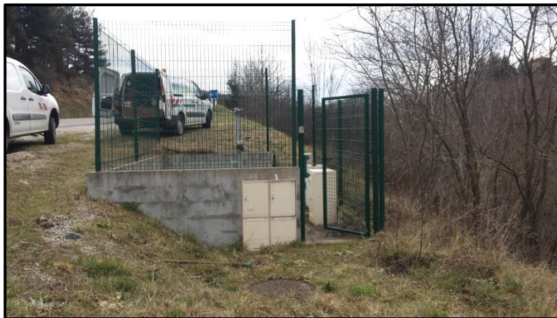
Photo 1 : Vue d'ensemble du poste
