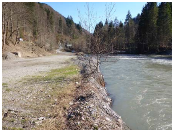
Merlons de curage déposés le long du remblai Jiguet en rive gauche à l'amont du pont de Nanchard
