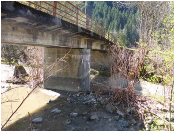
Le Doron sous le pont de Marcot (pile vulnérable à l'affouillement)
