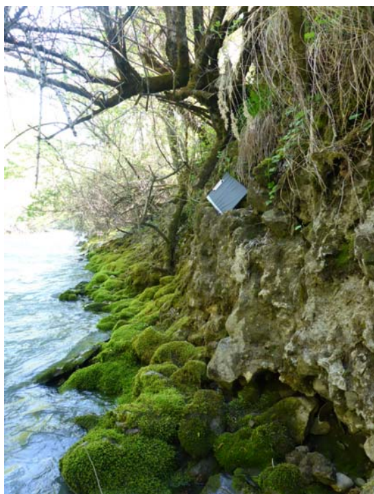
Berge rive gauche abrupte et composée d'anciens déchets des process des aciéries
