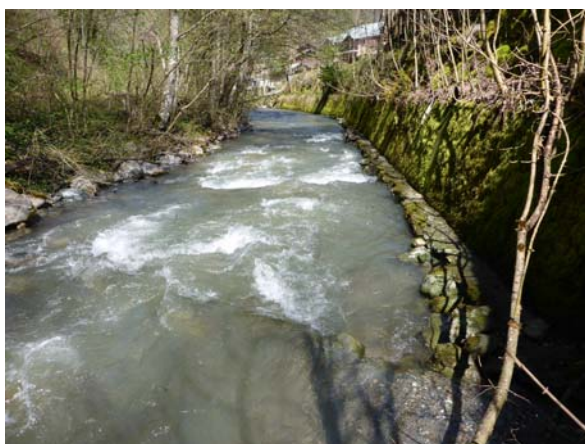
Radier à forte pente en aval de la salle polyvalente avec mur de protection de berge vulnérable
