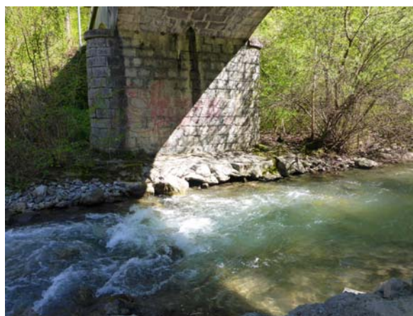
Affouillement des piles du pont des Bossons
