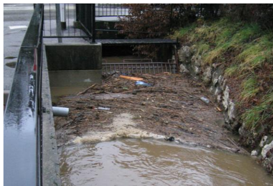
Montée d'eau et rétention des corps flottants par une grille.
