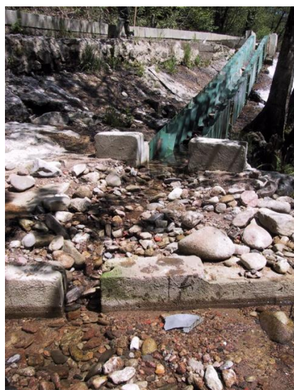
engravement d'une passe à ralentisseur après une forte crue : un nettoyage manuel de l'ouvrage est nécessaire.
