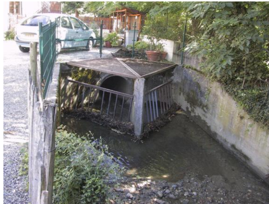
Grilles pour retenir les corps flottants avant un passage busé.
