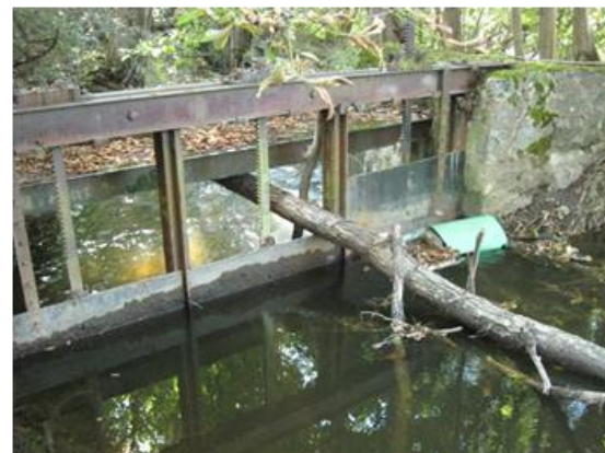
Blocage de bois dans une prise d'eau.
