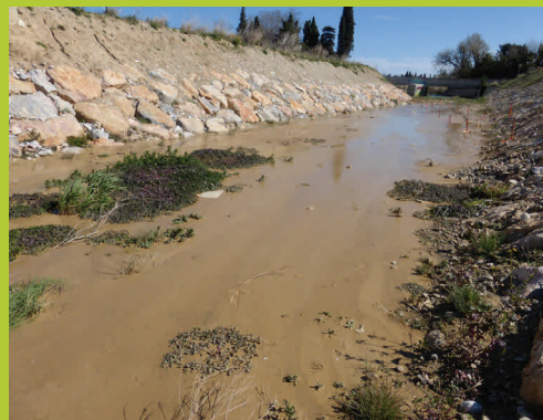
Colmatage complet du lit en aval des travaux (pk 981.8)
