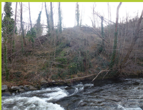
Boisements instables et en mauvais état sanitaire (pk 929.7)
