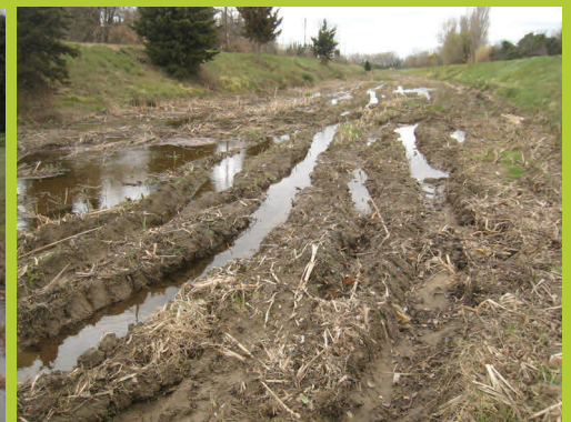
Entretien mécanisé, creusant des ornières (pk 974.6)
