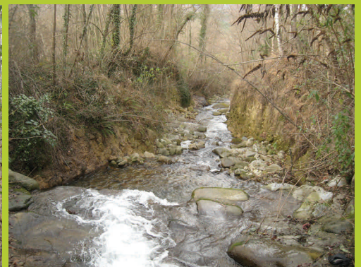
... et instable (pk 931.9)
