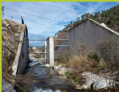
Piège à corps flottants en amont de Vernet-les-Bains (pk 61)
