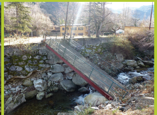
Pont privé, tombé dans le cours d'eau (pk 44)
