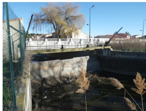
Photo 71 : Clapet basculant à l'amont de Bompas (AUQ08 – ROE51090)
