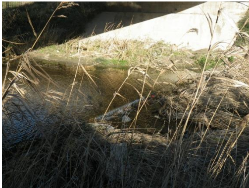
Photo 62 : Seuil bétonné sous le pont de la route menant au lieu-dit Aigues Vives (CIR01 – Non ROE)
