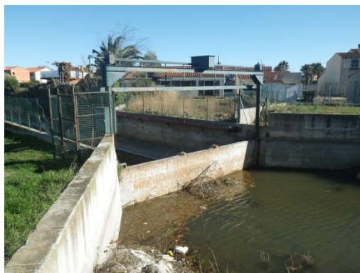
Photo 70 : Vanne relevable dans Bompas (AUQ07 – ROE51088)
