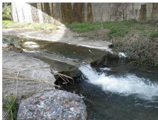
Photo 19 : Seuil de stabilisation du pont reliant la N116 à Prades (LLI02 – Non ROE)
