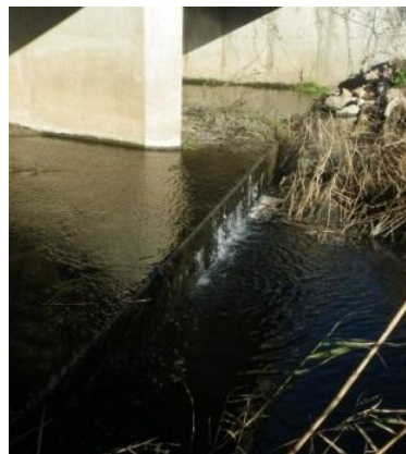
Photo 69 : Seuil sous un pont difficilement franchissable par les anguilles (AUQ02 – Non ROE)
