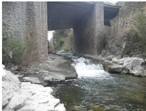
Photo 13 : Radier très difficilement franchissable du pont de la N116
