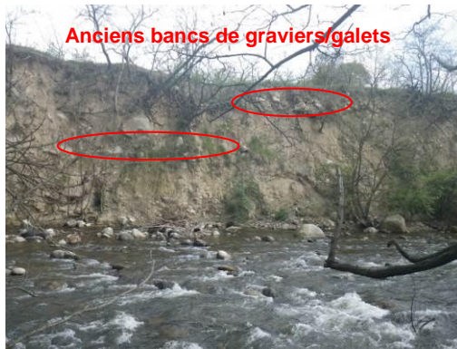
Photo 17 : La Têt en amont de la station d'épuration de Prades – menace sur le canal de Marquixanes
