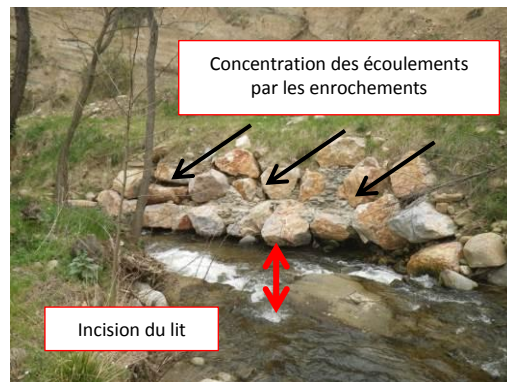
Photo 74 : Enrochements du pied de berge rive droite et incision du lit
