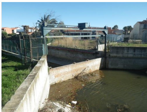
Photo 166 : Vanne relevable dans Bompas (AUQ07 – ROE51088)
