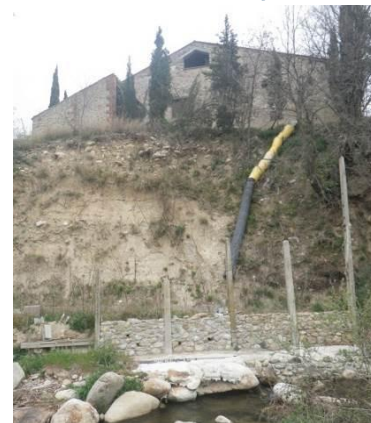
Photo 70 : Erosion rive droite au pied d'une maison derrière une protection artisanale et rejets de débris solides
