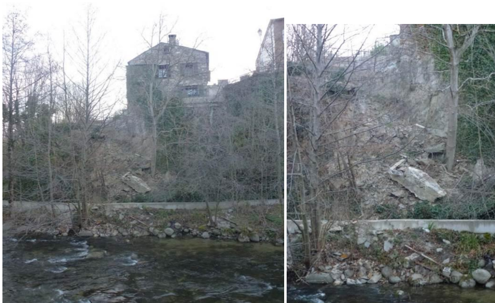
Photo 13 : Erosion en rive droite à l'aval du pont de Joncet du Bac - Pk 929,25 (Source : CCEAU)
