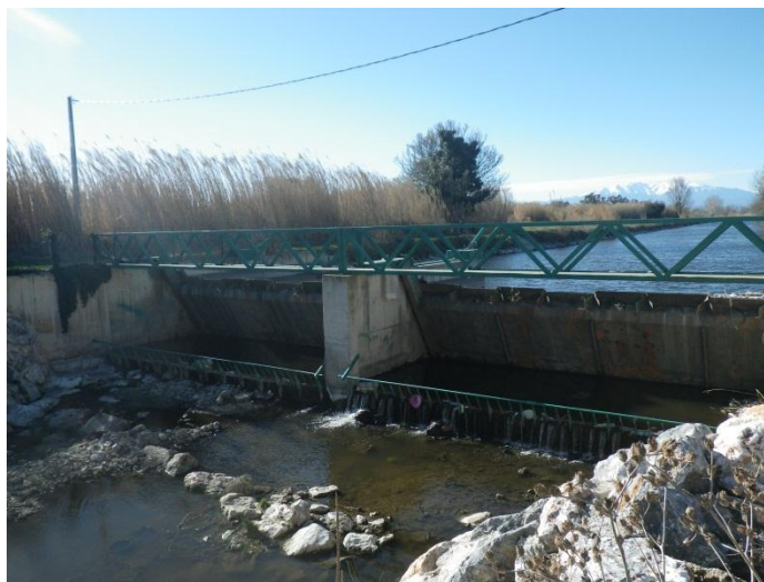
Photo 163 : Seuil et clapets basculants au niveau du lieu-dit « el Vegueriu Baix »
