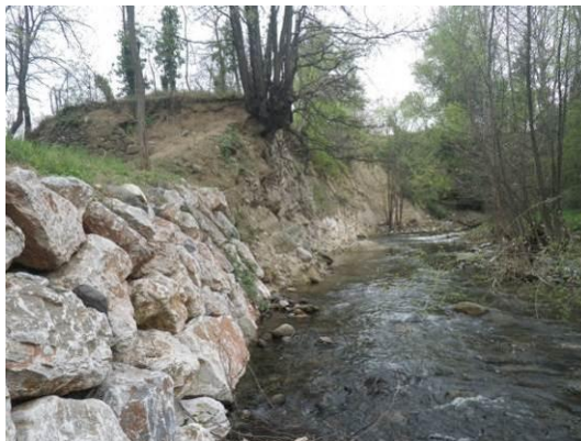
Photo 58 : Erosion rive droite en face du village de Catllar - chemin du Languedoc
