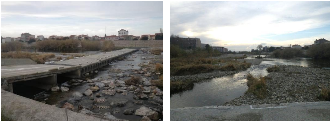
Figure 22 : Gué du palais des expositions – accumulation de matériaux en amont (TET04 - ROE36188)
