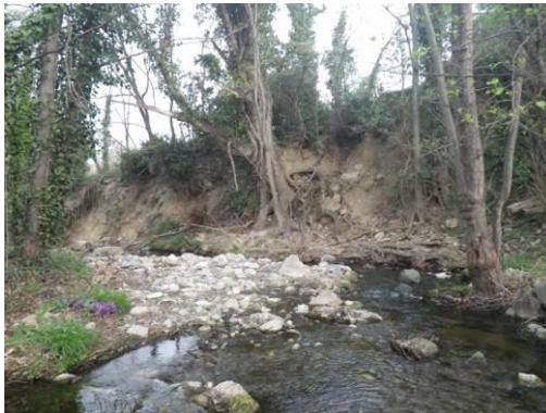
Photo 67 : Erosion rive droite - menace d'un verger
