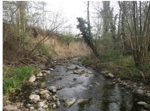
Photo 68 : Erosion rive gauche - menace d'un chemin d'accès chez un particulier
