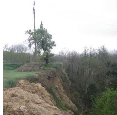
Photo 66 : Erosion rive gauche au niveau du lieu-dit les Costes - menace d'un poteau électrique
