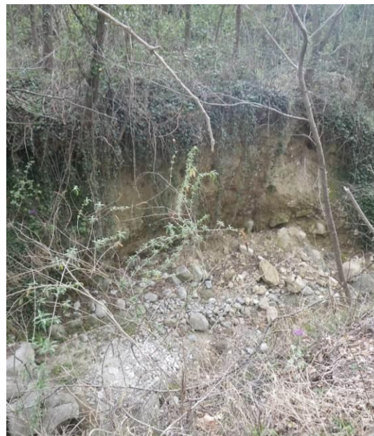
Photo 44 : Erosion en rive gauche à l'aval du seuil de stabilisation du pont de la D116
