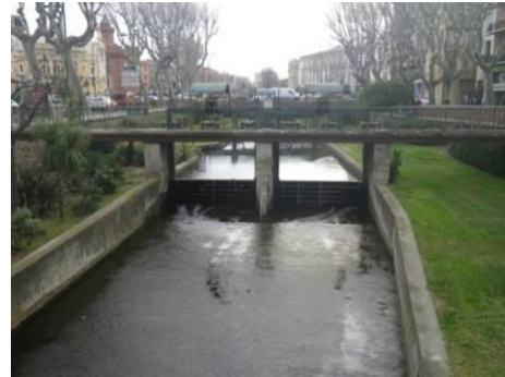
Photo 156 : Vannes relevables sur la Basse aval (BASo2 – ROE45479)
