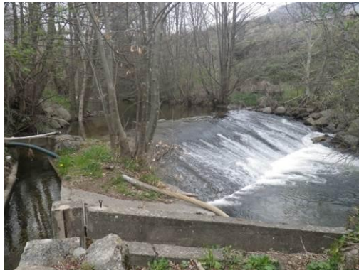
Photo 55 : Prise d'eau au niveau du domaine Saint-George
