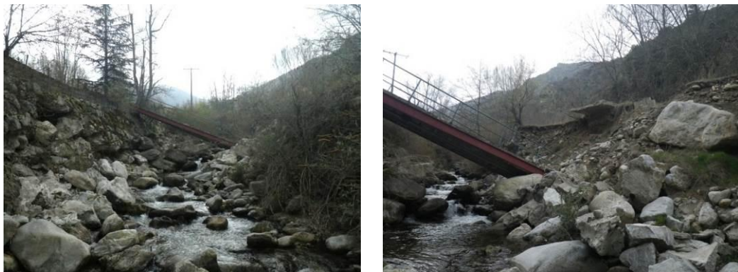
Photo 39 : Passerelle chutée dans le lit en aval de la commune de Casteil
