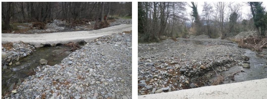
Photo 122 : Gué busé en amont de la RN116 et matériaux stockés en amont
