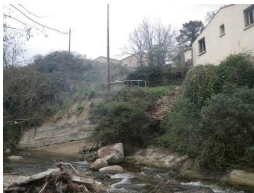
Photo 71 : Erosion rive gauche amont
