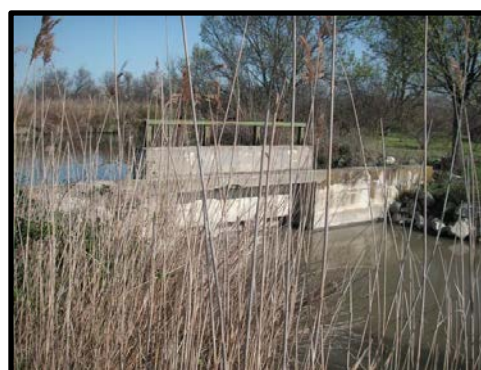
Figure 28 : Martelière de saint Clément sur le Vistre (ONEMA)
