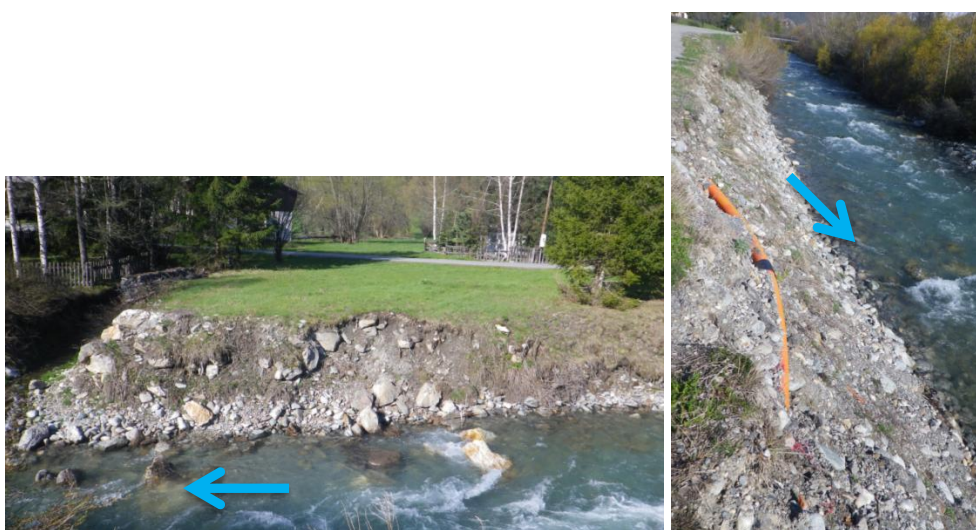
Fig. 74. Erosions de berges observées au PK14700 et sur le tronçon PK14500-14100
