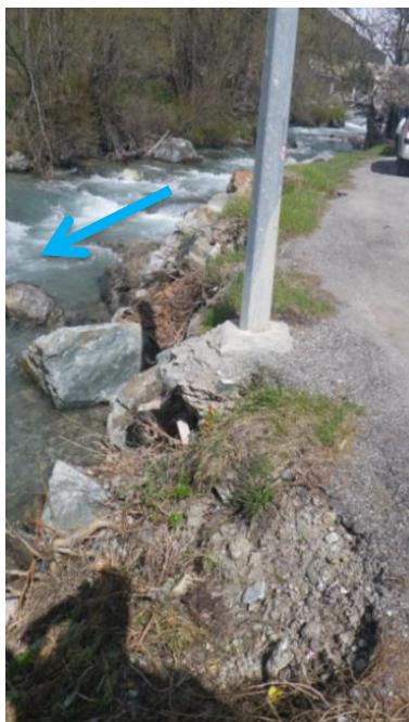
Fig. 71. Erosion de la berge rive gauche de la Guisane en aval du Casset (PK17350-17300)
