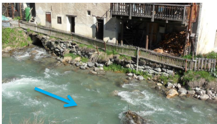
Fig. 29. Protections de berges faibles dans la traversée de Chantemerle
