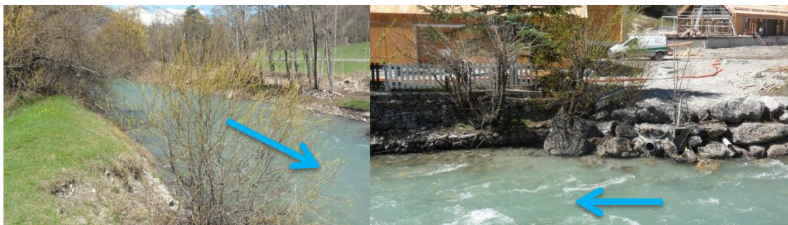
Fig. 27. Digue et protections de berges au droit de la base de loisirs en amont de Chantemerle
