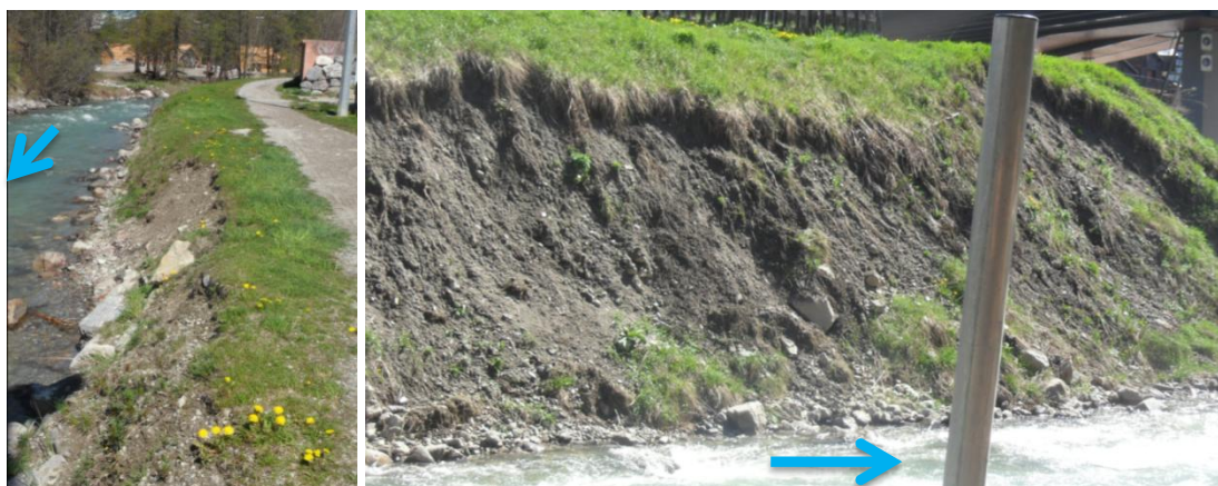
Fig. 88. Erosions de berges observées au PK 6650 et en amont du PK6400
