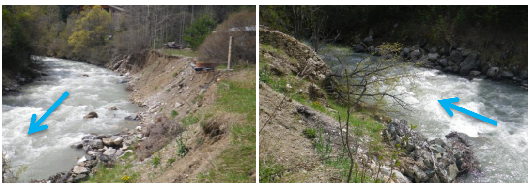
Fig. 92. Rive gauche de la Guisane : érosion au PK2200-2100 et gabions déstabilisés au PK2100-2000
