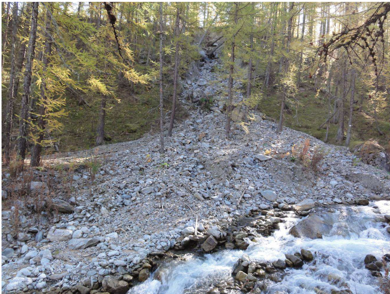
Photo 13 : Effet d'un trop plein et érosion de la berge du Grand Tabuc.
