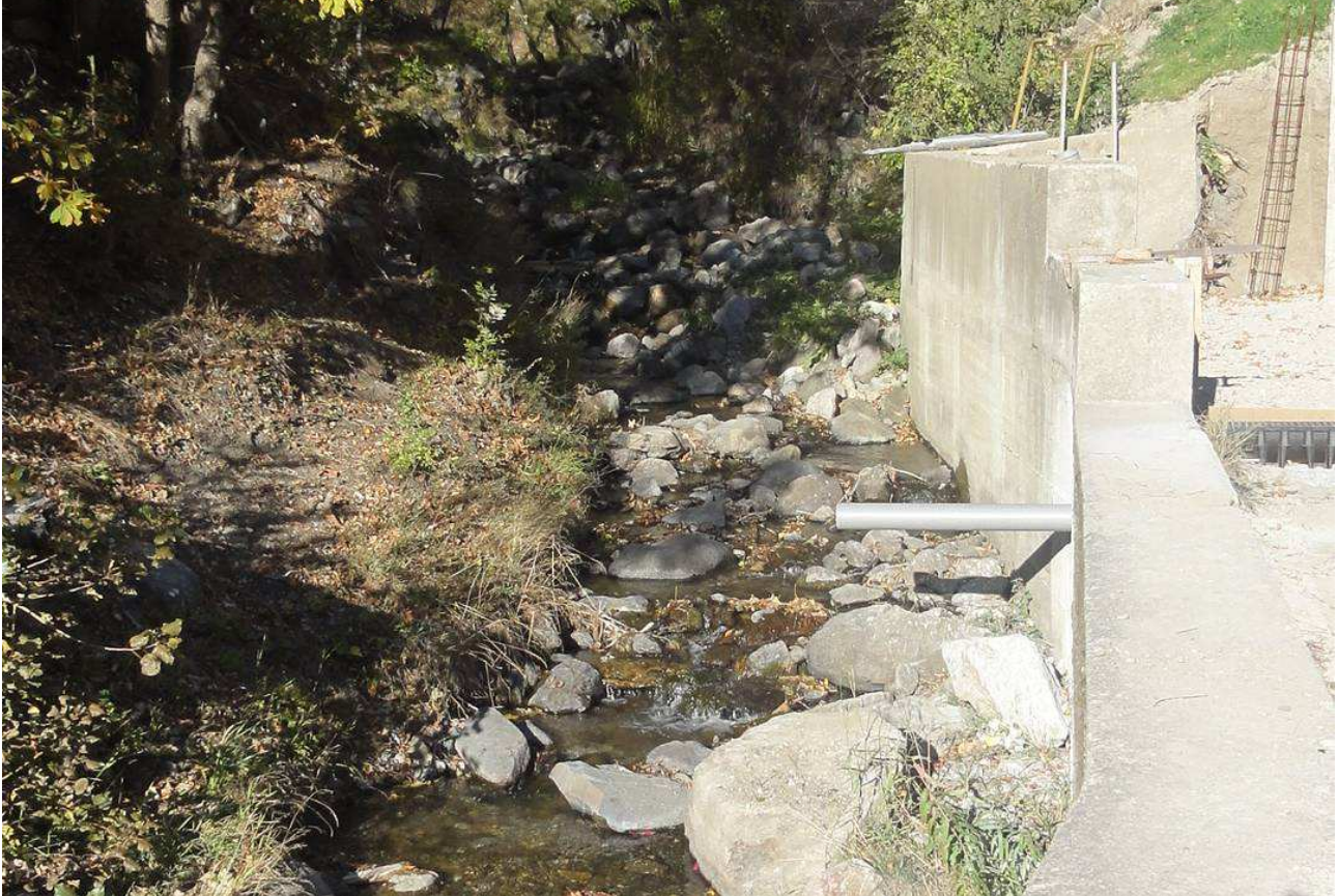
Photo 46 : Section très hétérogène sur le cône de déjection du torrent de S t Bernard.
