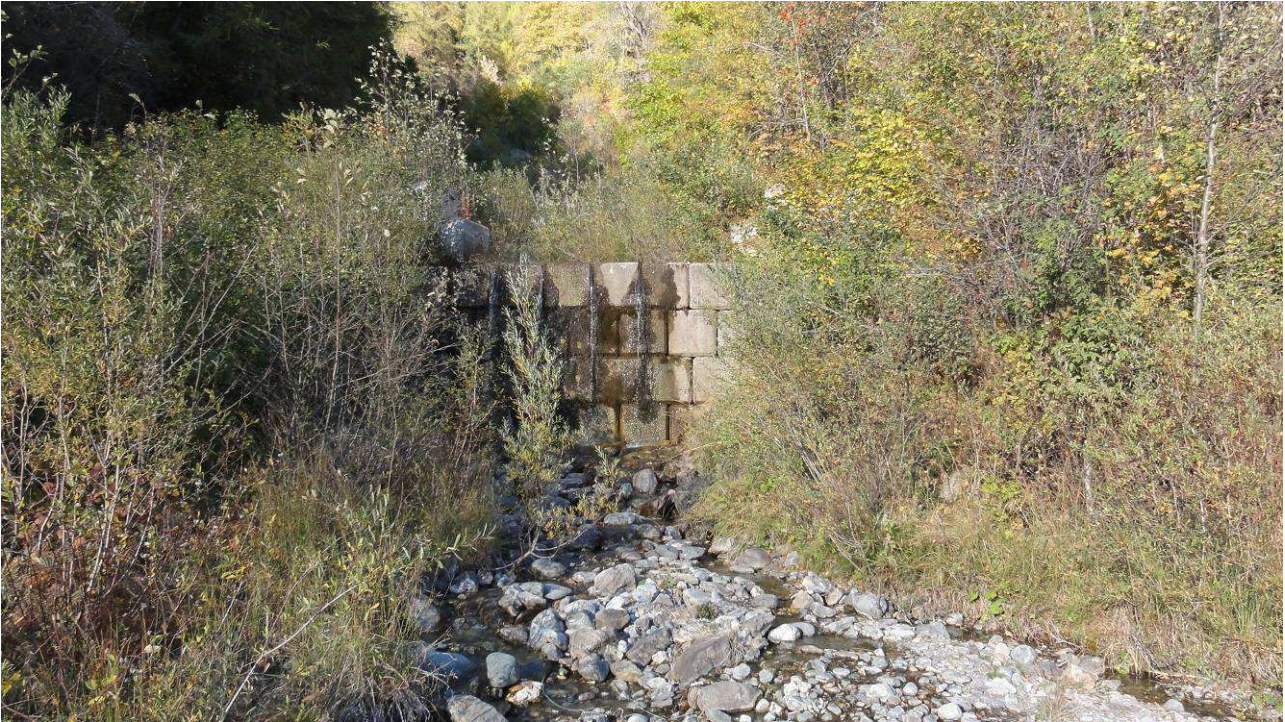
Photo 6 : Barrage et lit apparemment sans transport solide important.
