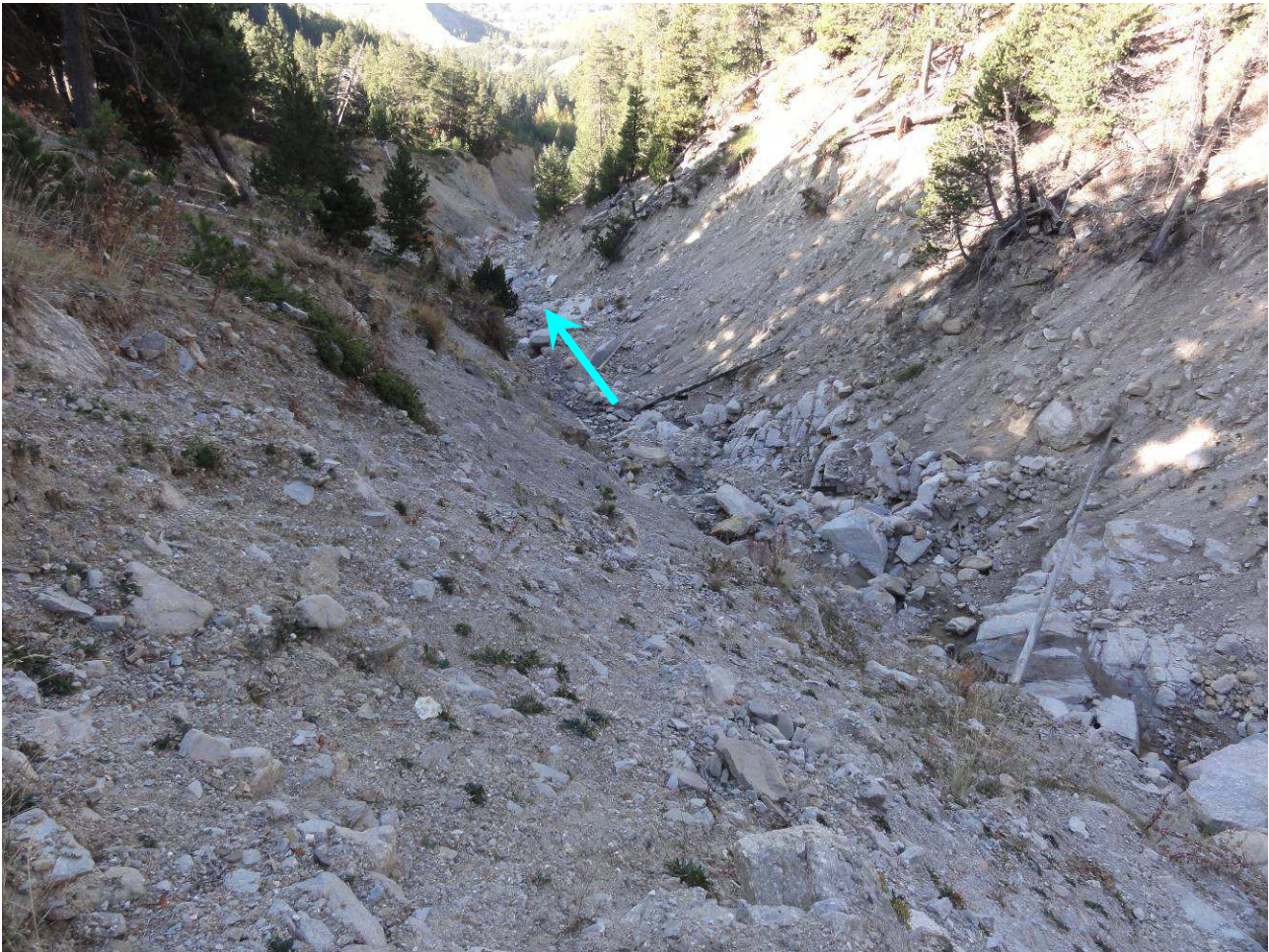
Photo 55 : Érosion active le long du lit du Verdarel.
