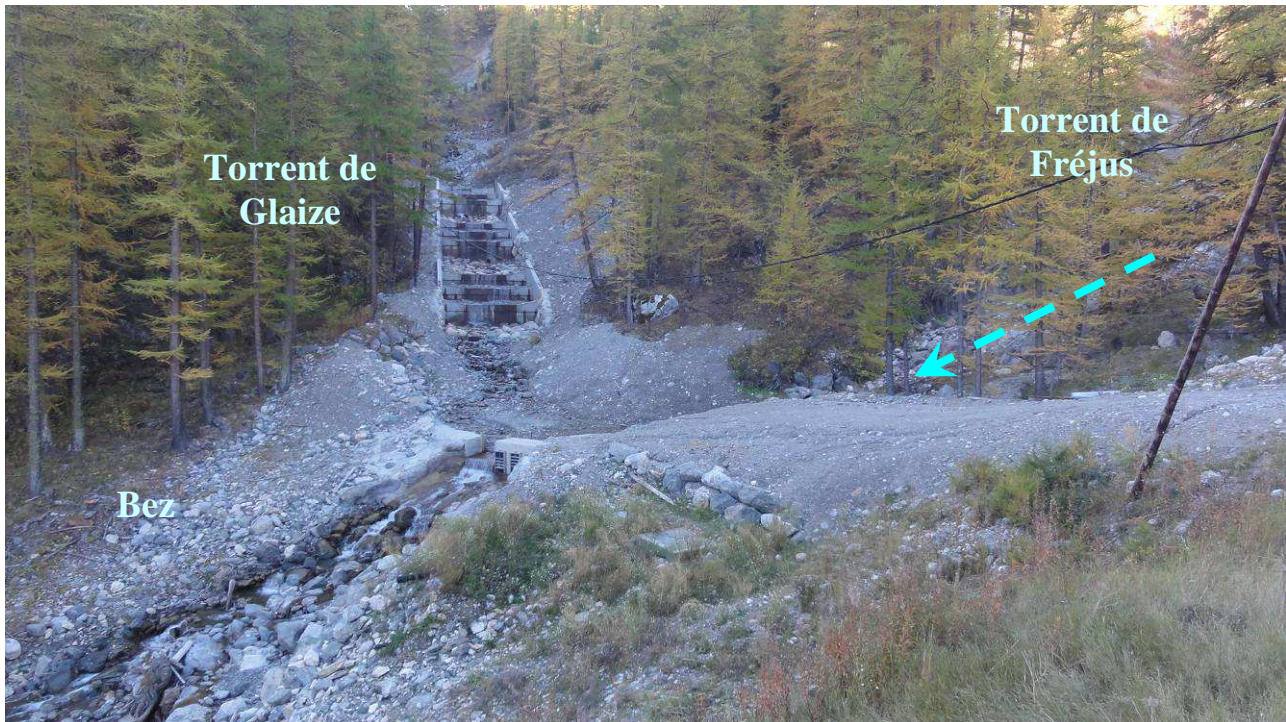
Photo 33 : Barrages récents en amont de la prise d'eau pour l'alimentation de l'enneigement.
