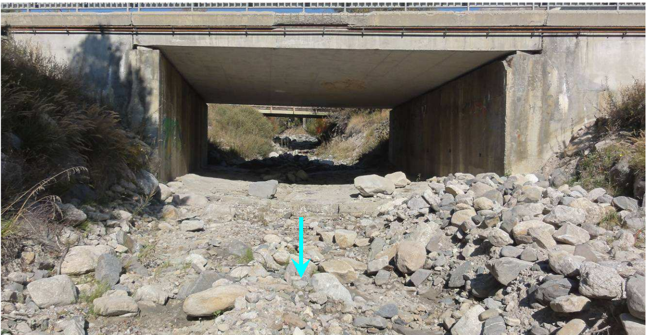
Photo 62 : Pont de la RD1091 et passerelle en amont avec une faible hauteur.
