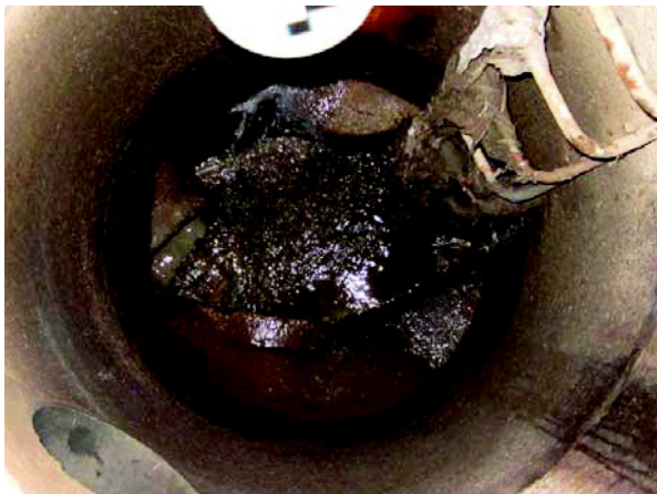
Importantes infiltrations dans un regard de visite
