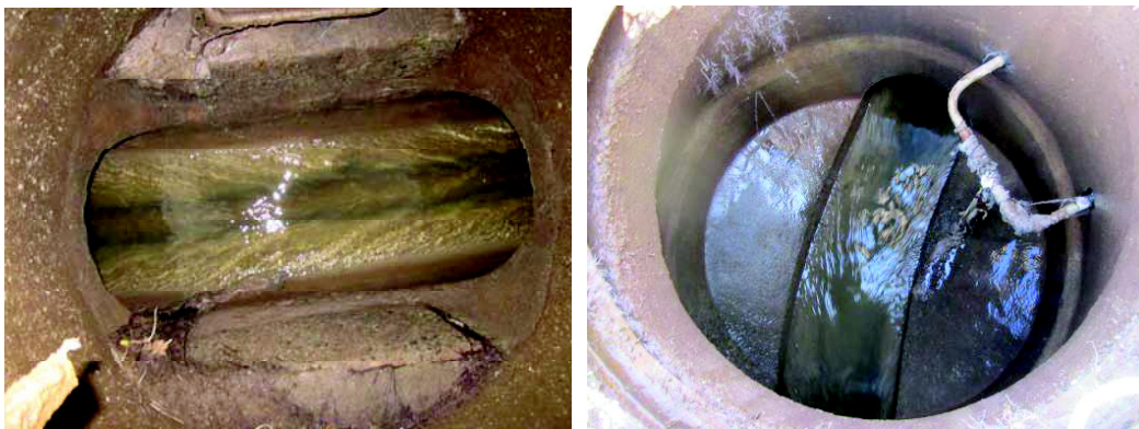
Infiltrations visibles à 0.5 m de profondeur
