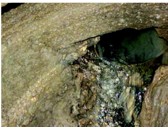
2.5 l/s d'ECPP et infiltrations visibles sur le secteur
