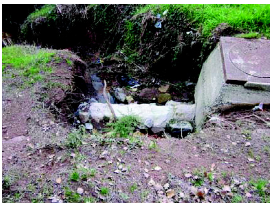
Canalisation en mauvais état (environ 1.5 l/s mesuré la nuit)
