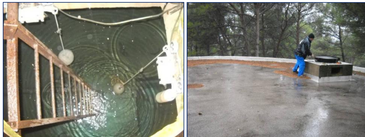
Illustration 12 : Réservoir de Fontanille, vue extérieure et intérieur du bassin
