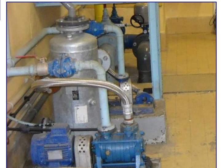
Illustration 6 : Pompe de mise en dépression des conduites d'aspiration et des chambres des pompes.
