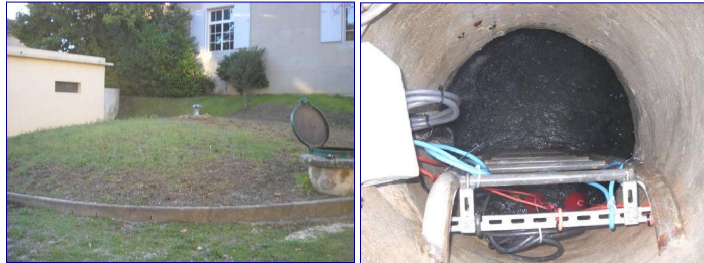
Illustration 9 : Bâche de la station du centre ville.
