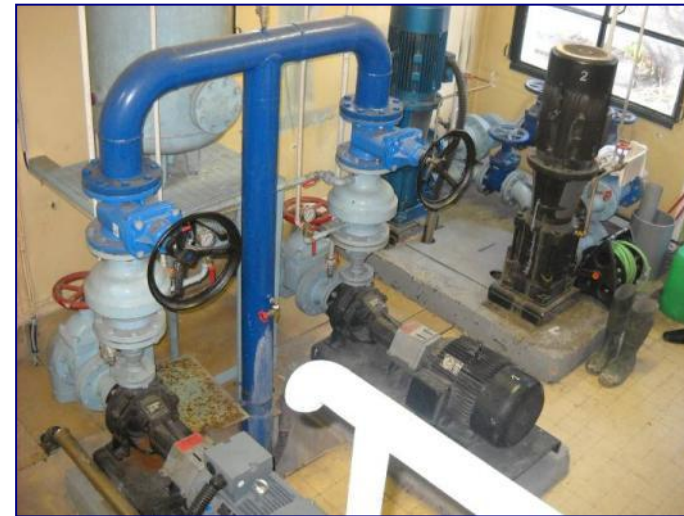
Illustration 5: Groupe de pompes alimentant le réseau du Fontanille (en bas à gauche) / Groupe de pompes alimentant le réservoir de Foussa (en haut à droite).
