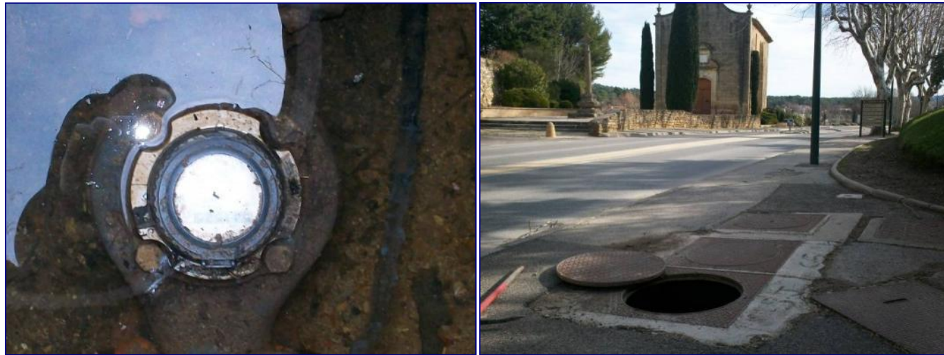
Illustration 4 : Point de comptage des volumes vendus à la commune par la SCP pour la partie centre ville
