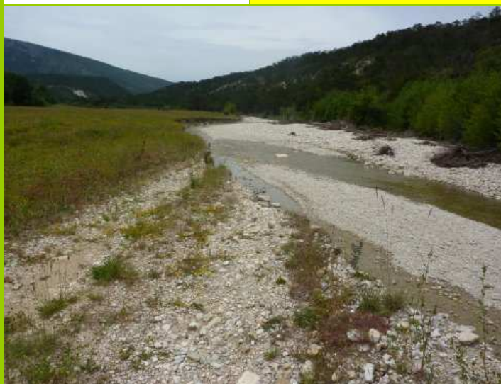
Erosion de berge en plaine agricole de la Braïsse Vue vers l'aval
