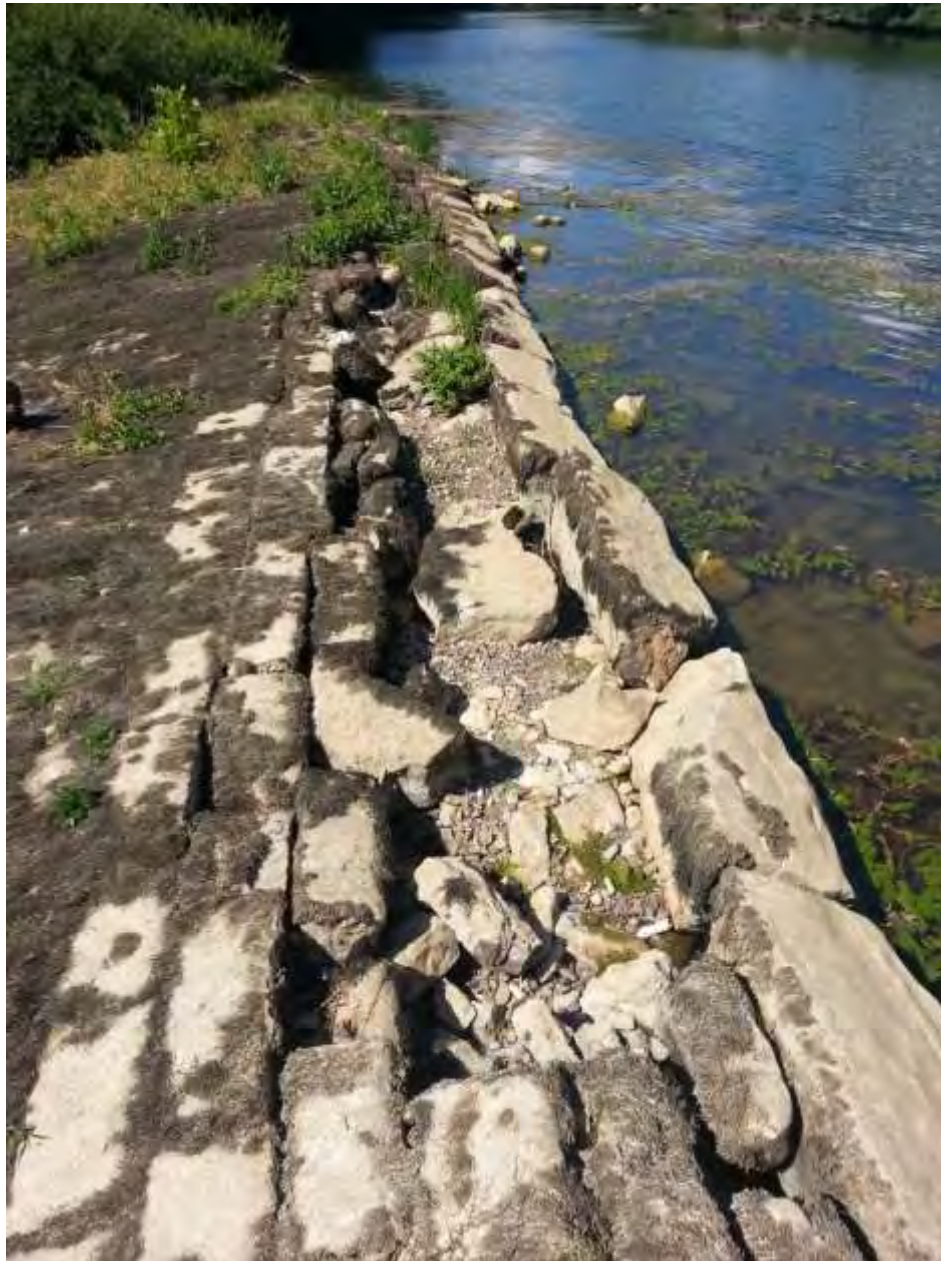
Etat du parement amont
