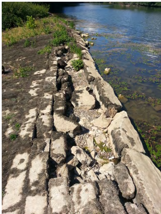
Etat du parement amont
