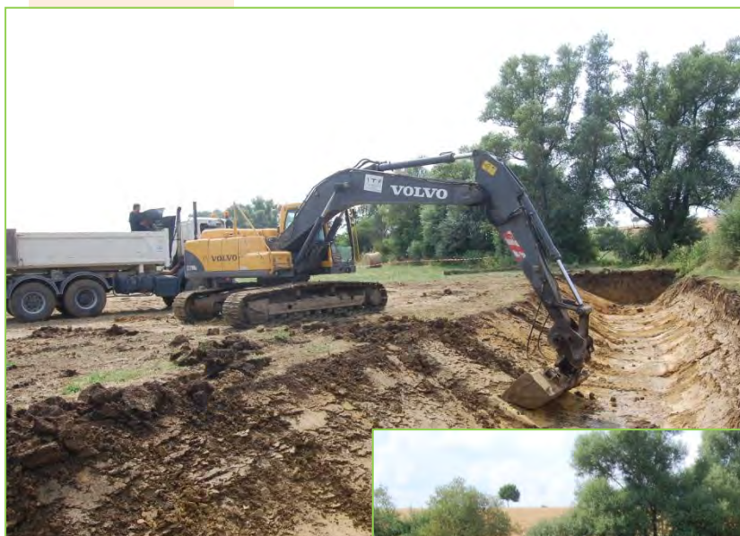
Illustration des travaux de terrassement en deux temps pour dessiner le lit et ensuite travailler ce dernier
