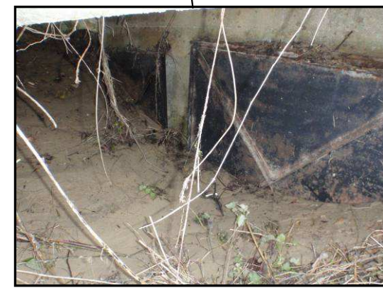
Absence de restitution aux clapets, fortement ensablés
