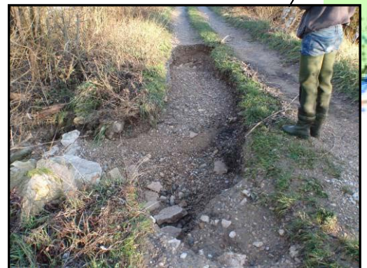
Chemin de berge dégradé par l'érosion lors des surverses de la Loue au niveau de l'exutoire.
