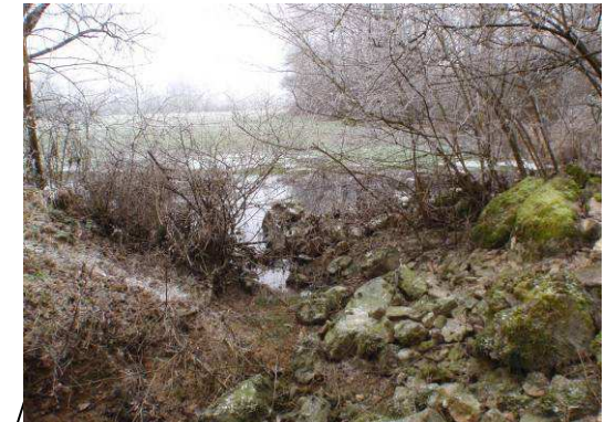
Rupture de l'écoulement au niveau de la brèche de la digue.
