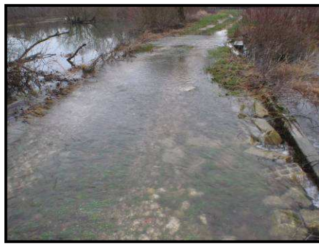
Jonction Pommeret/Macchabée, l'eau passe sur le chemin
