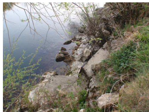
Absence d'écoulement au niveau du clapet
