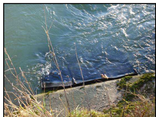
Clapet ouvert, conduisant à un drainage rapide des Mortes. Exutoire de l'ensemble des deux mortes.
