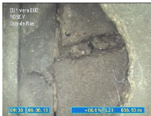
Figure 11 : Effondrement partiel de la canalisation
