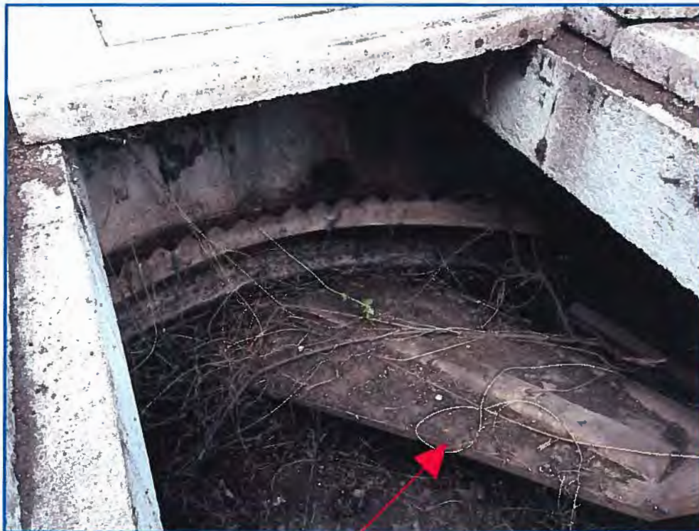
Cône de décantation cassé
