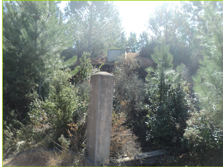
Figure 7 : Réservoir communal hors service
