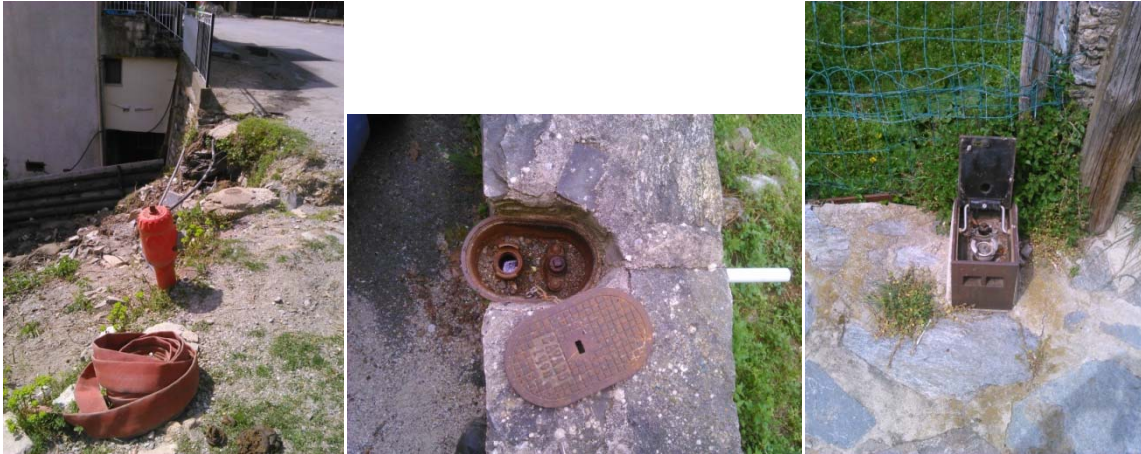
Figure 20 : Poteau et bouches à incendie
