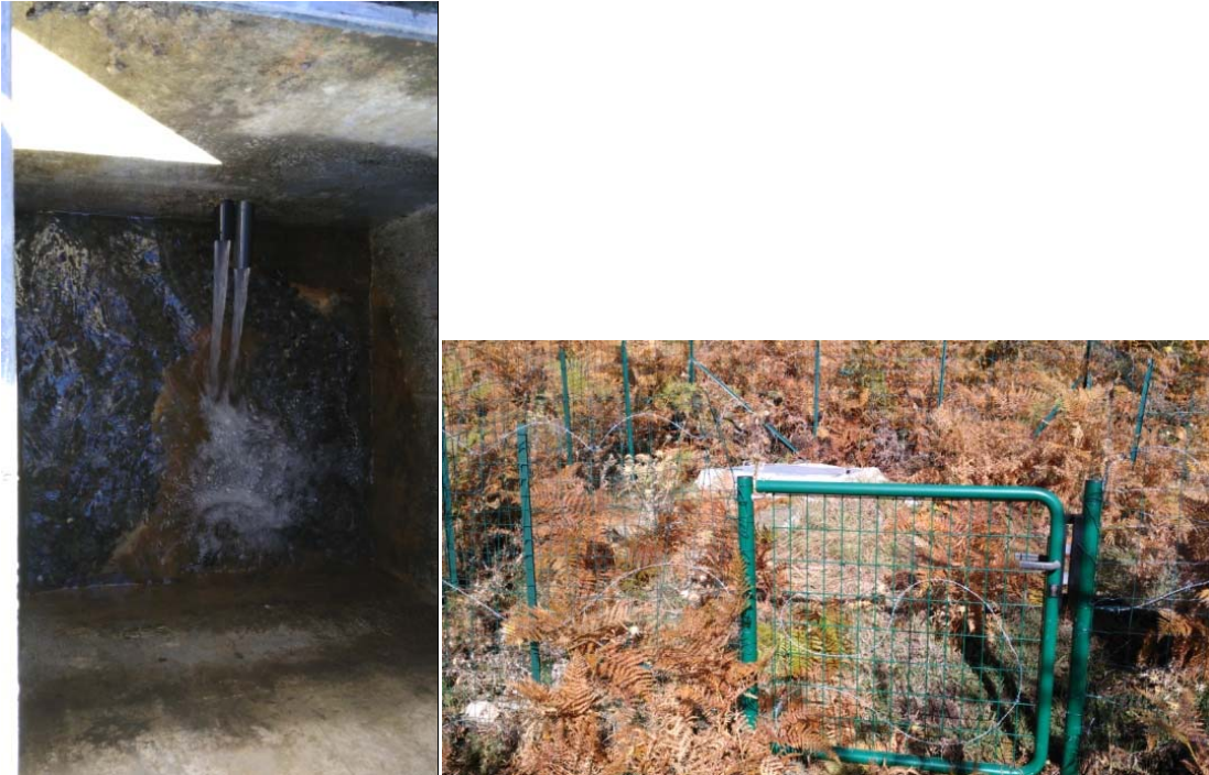
Figure 13 : Vues extérieure et intérieure du captage de Favaltu
