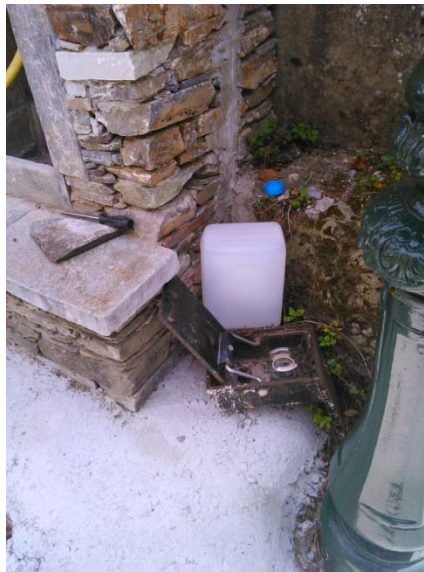
Figure 25 : Bouche à incendie à Campodonico
