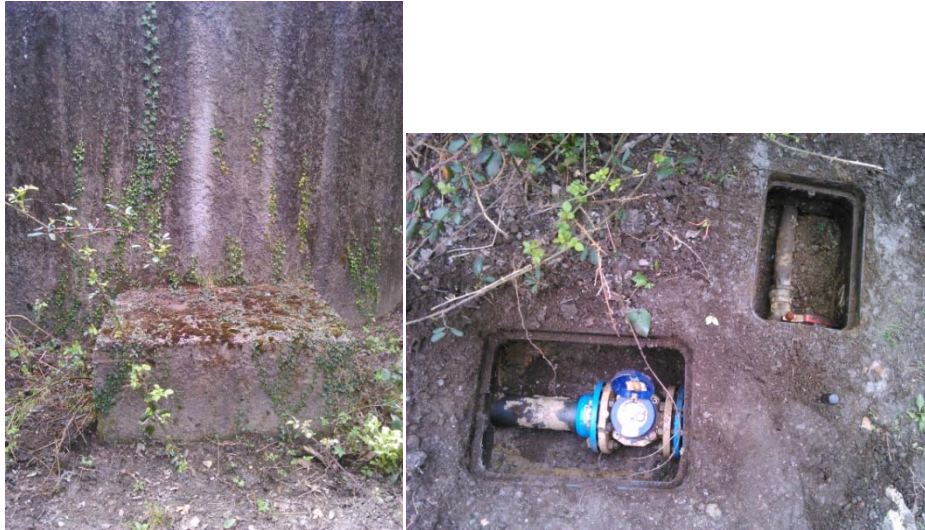
Figure 17 : Chambre des vannes, compteur distribution et bypass
