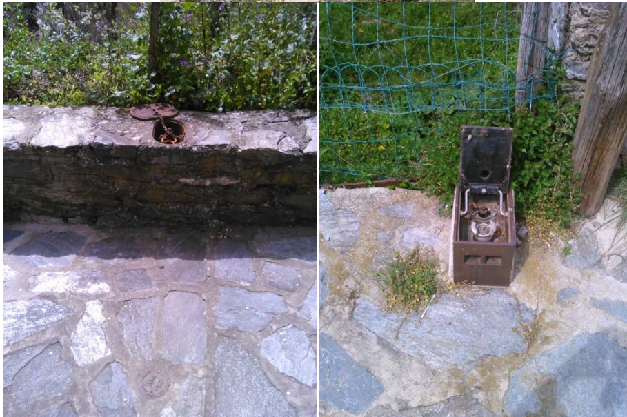
Figure 24 : Poteau à incendie et bouches à incendie à Pie d'Orezza
