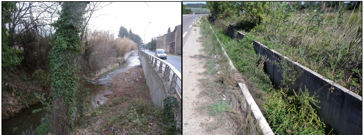
Photos 9 : absence de végétation sur les secteurs canalisés
