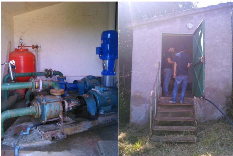
Photo 12 : Station de pompage de la Punta
