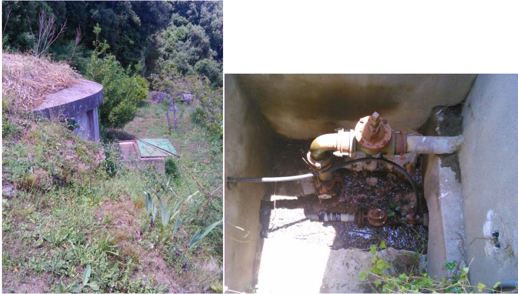
Photo 10 : Réservoir de Bozzi et sa chambre des vannes
