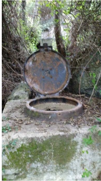
Photo 7 : Captage de Funtanone 1
