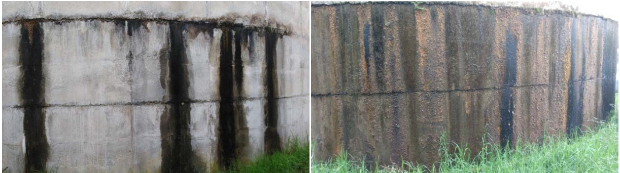
Photo 11 : Fissures sur le réservoir de Dirudu
