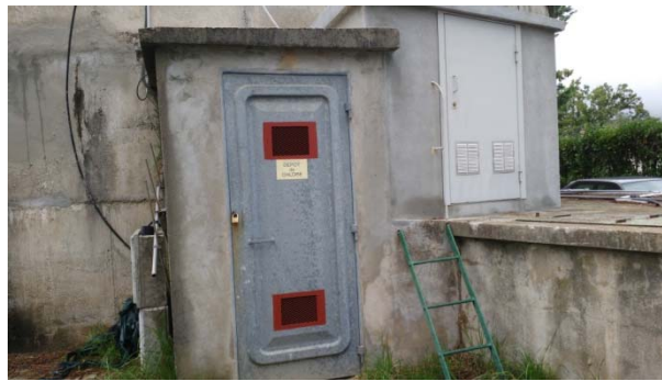
Photo 14 : Cabine de chloration de Dirudu
