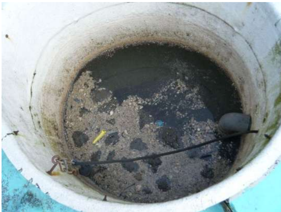
Photo N°5 : Lumière du clarificateur avec quelques remontées de boues à couler et quelques flottants à évacuer.
