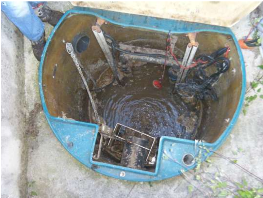
Photo N°1 : Poste de relevage avec panier dégrilleur.
