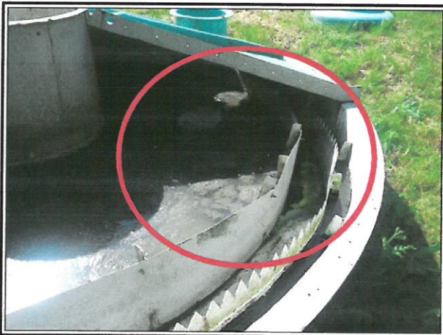
Illustration 3: Autre vue du clarificateur.
