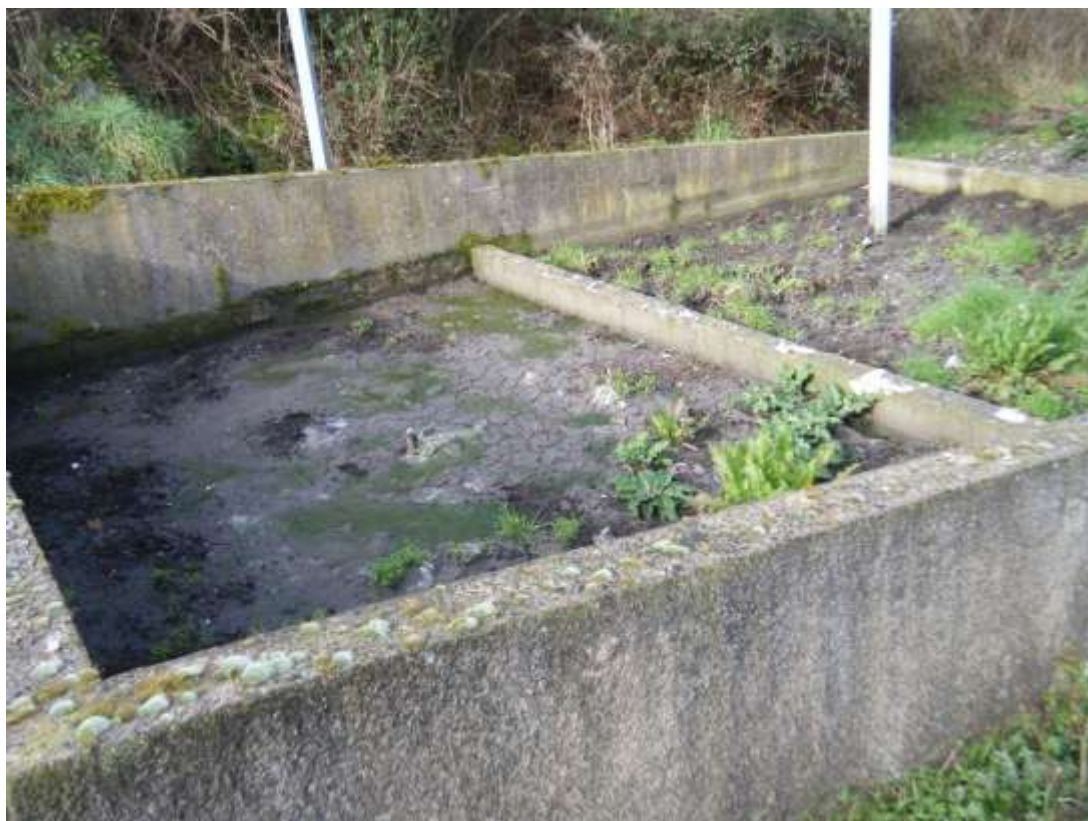
Photo N°3 : Boues humides présentes sur les lits de séchage (à évacuer avant de relancer un soutirage).
