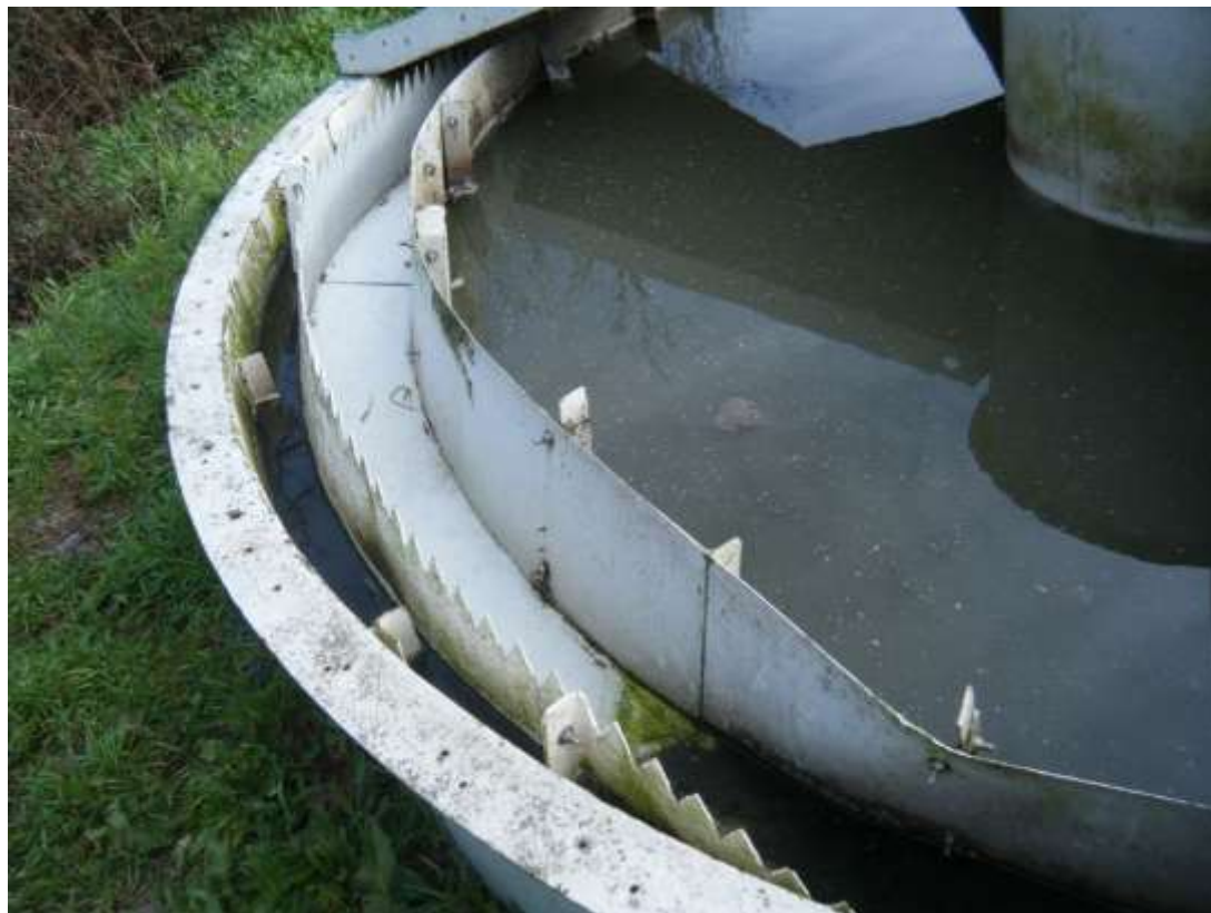
Photo N°6 : Goulotte de reprise d'effluent du clarificateur soulevée.
