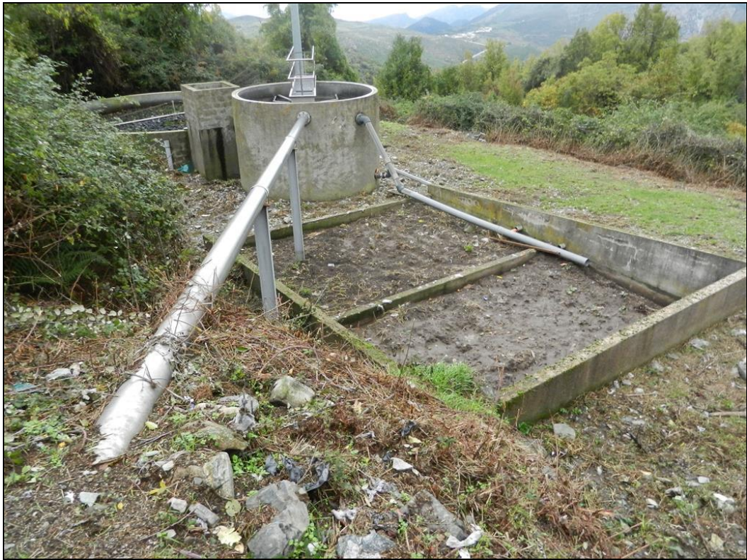
Photo 10 : Lit de séchage et décanteur digesteur de la station du ruisseau
