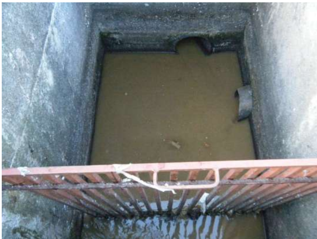
Photo N°3 : Arrivée très concentrée d'effluent à 8H15.
