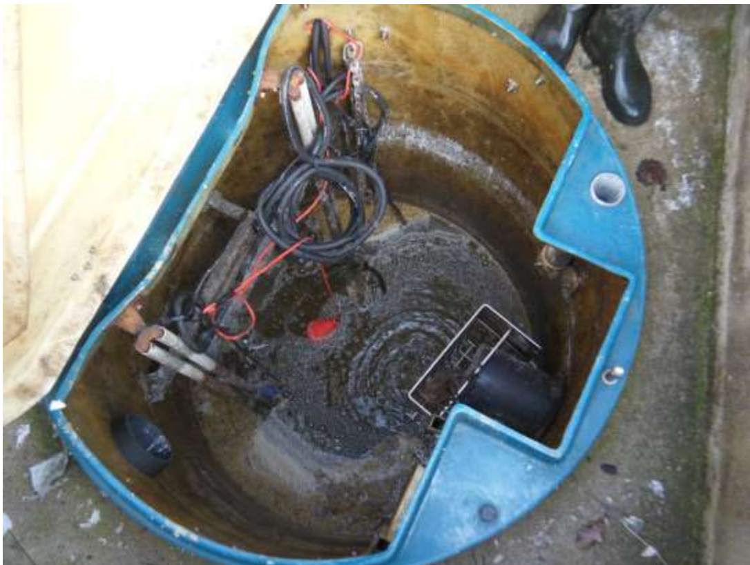
Photo N°1 : Poste de relevage avec un peu de graisses en surface. A noter la présence du panier dégrilleur.
