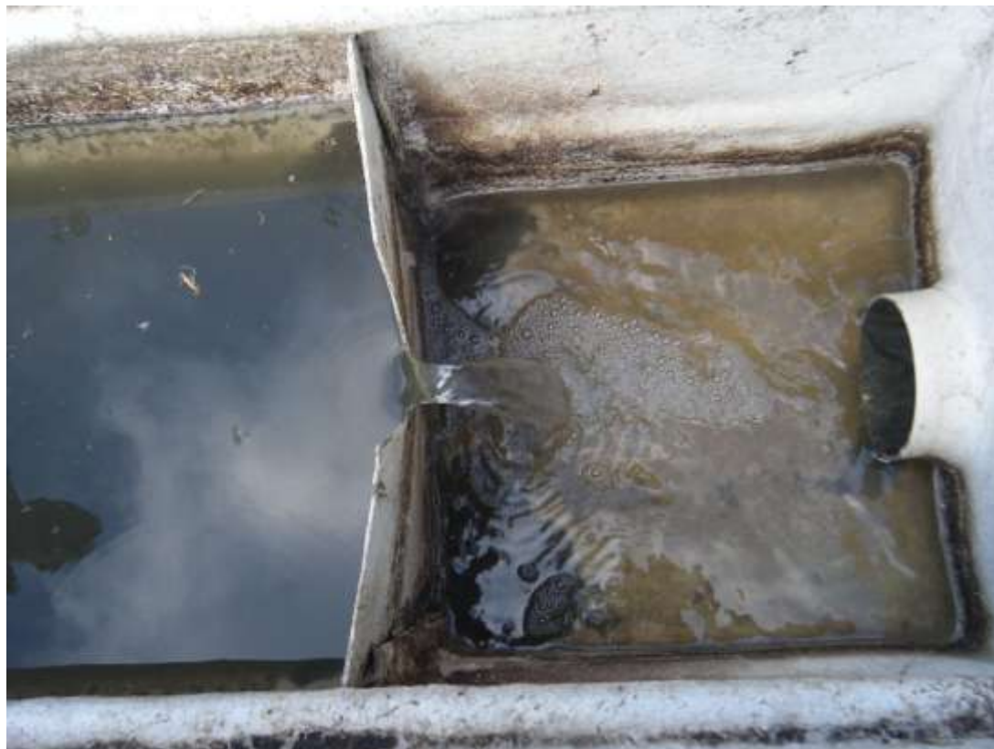
Photo N°8 : Canal de sortie de l'effluent traité. Sortie plus claire que lors des précédentes visites avec moins de départs de matières en suspension.
