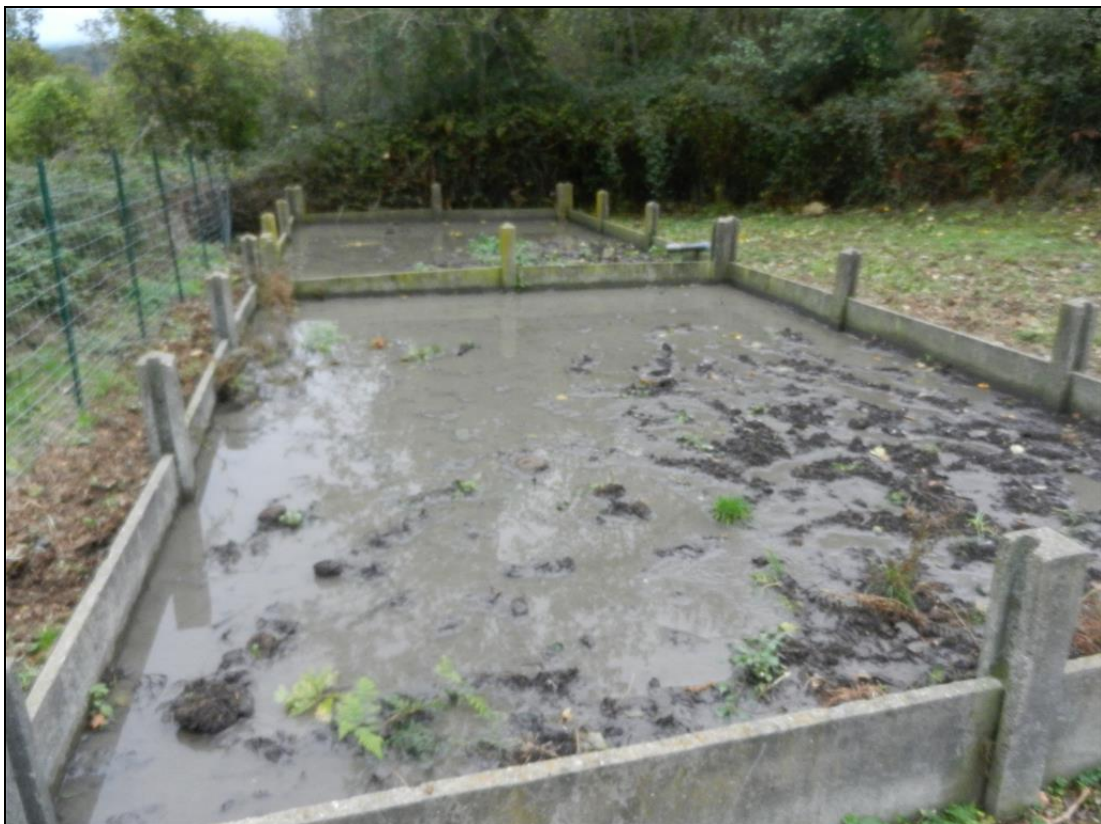
Photo 8 : Lits de séchage des boues de la station du stade (11/2013)
