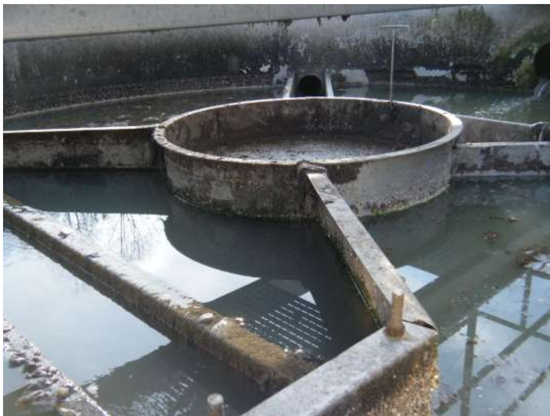
Photo N°1 : Surface du décanteur digesteur propre.
