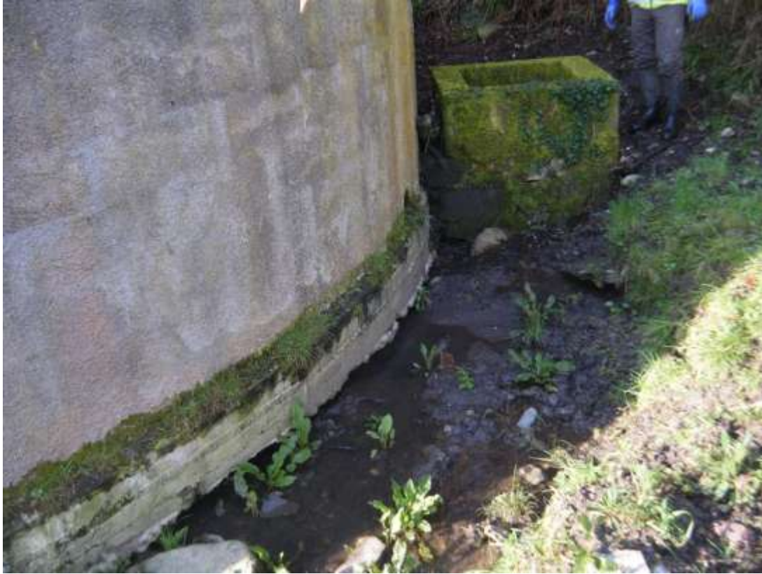
Photo N°5 : Source qui s'écoule au dessus du regard de sortie du lit bactérien et qui détrempe le sol au pied du lit bactérien.
