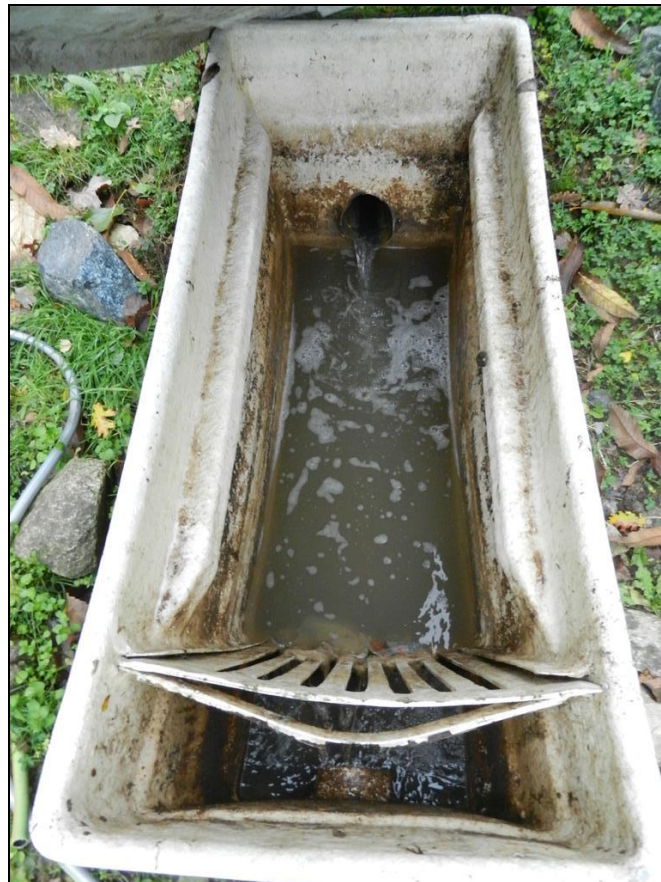
Photo 4 : Dégrilleur statique de la station du stade
