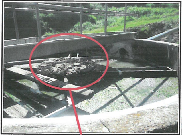
Illustration 2: Le décanteur-digester est colmaté par des boues sèches en surface.
