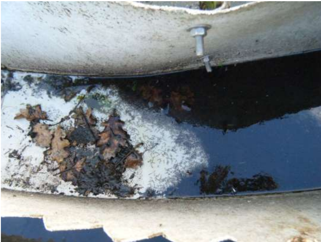
Photo N°6 : Larves de moustiques (par milliers) dans la goulotte du clarificateur.
