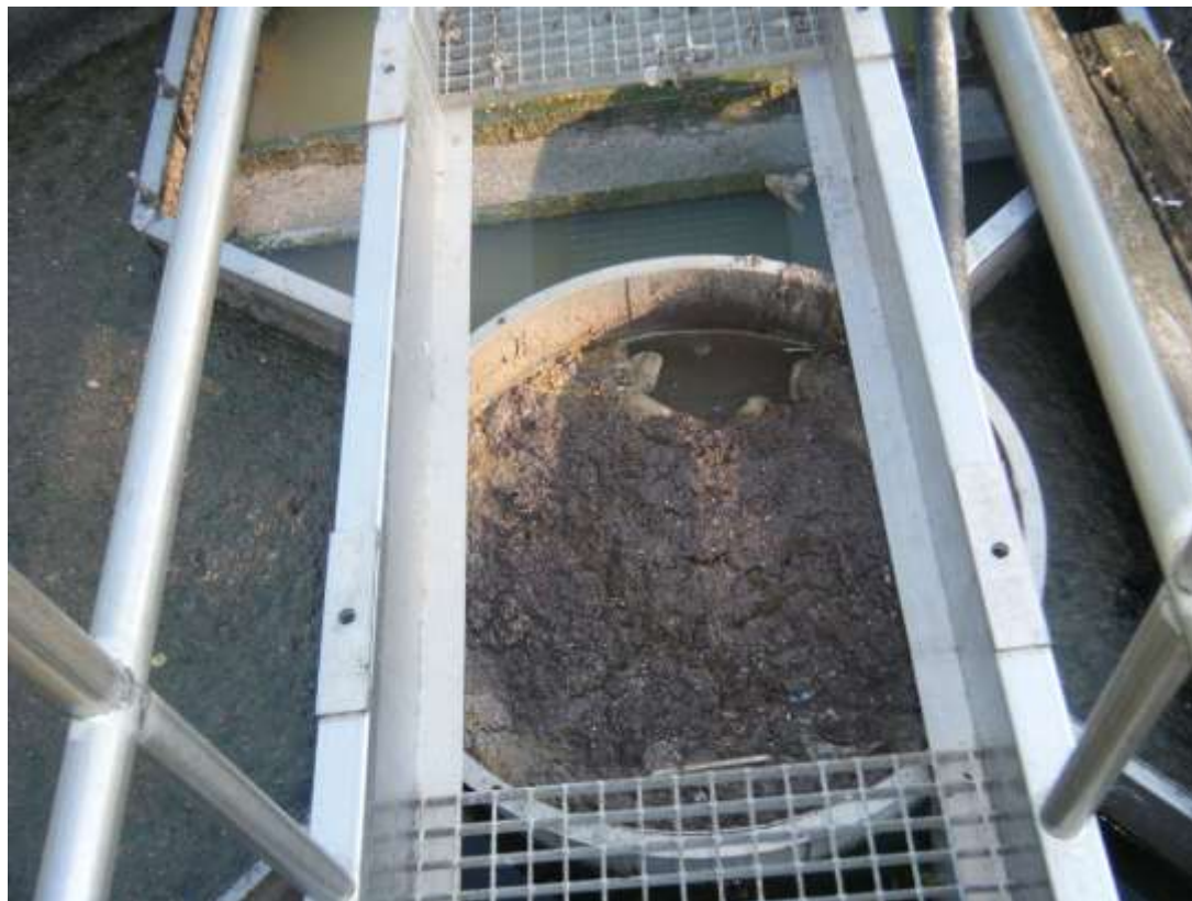
Photo N°2 : Remontées de boues au centre de l'ouvrage et sur les côtés à couler au maximum à la pelle dans l'attente de la mise en place d'un point d'eau potable avec pression.
