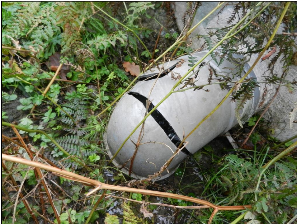
Photo 7 : Canalisation de transfert endommagée
