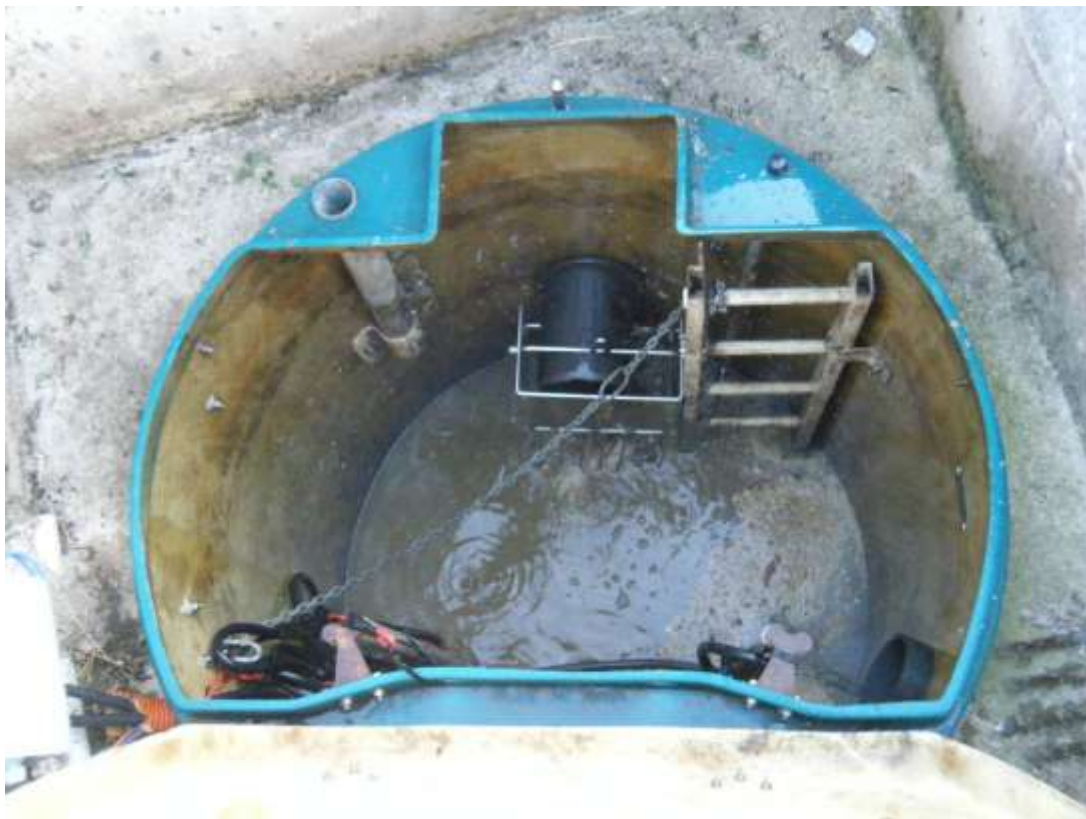
Photo N°1 : Poste de relevage nettoyé la veille de la visite SATESE. A noter la présence du panier dégrilleur.
