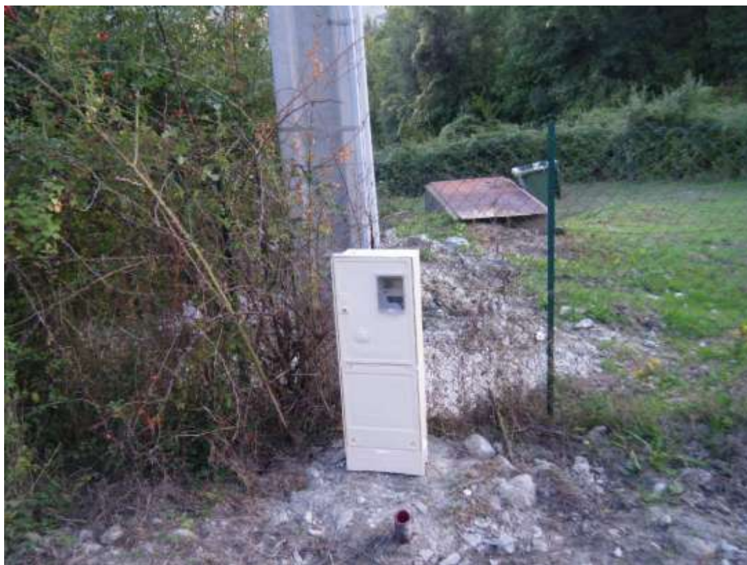
Photo N°1 : Compteur EDF placé récemment (destiné à la station d'épuration ?) avec réservation. En arrière plan, dégrilleur statique et poubelle destinés à réceptionner les déchets dégrillés.
