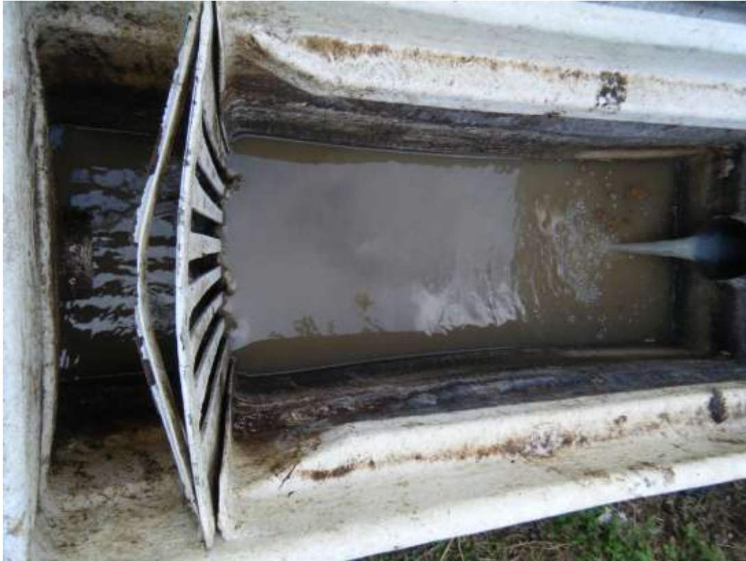
Photo N°3 : Grille statique du dégrilleur.
