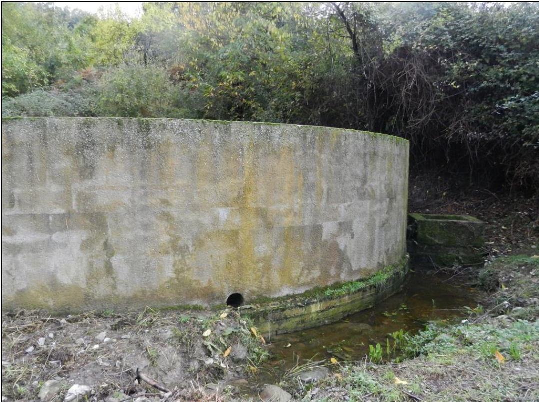
Photo 12 : Défaut d'étanchéité au niveau du lit bactérien de la station du ruisseau
