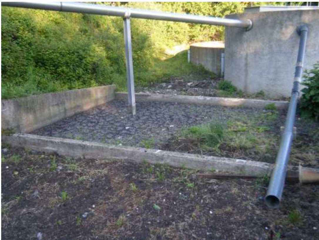
Photo N°3 : Boues à évacuer du lit de séchage le plus proche du décanteur digesteur. Déchets dégrillés mélangés aux boues sèches au pied du décanteur à ratisser et à envoyer en décharge.
