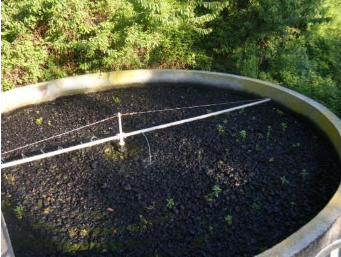
Photo N°5 : Bon développement de la zoogée sur la pouzzolane du lit bactérien malgré que les trous de répartition d'un des deux bras du sprinkler soient pratiquement tous colmatés.
