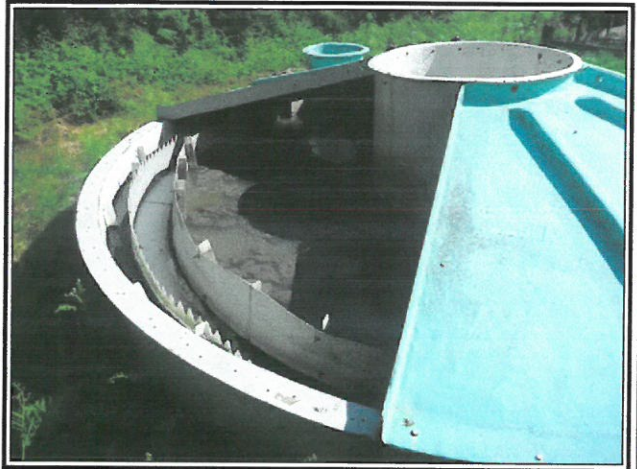
Illustration 2: Vue du clarificateur, ce dernier est détérioré – Remontées de boues en surface.
