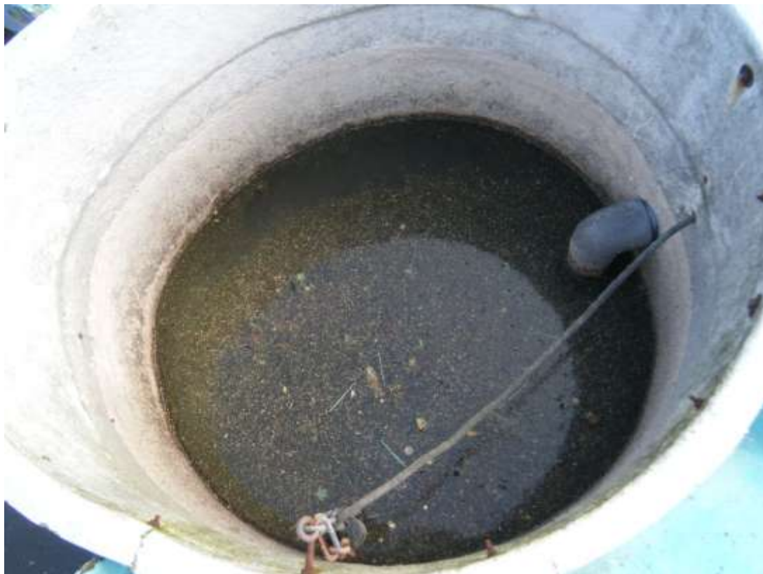
Photo N°7 : Absence de remontées de boues dans la lumière du clarificateur (effet des nouveaux réglages de la pompe de recirculation ?).
