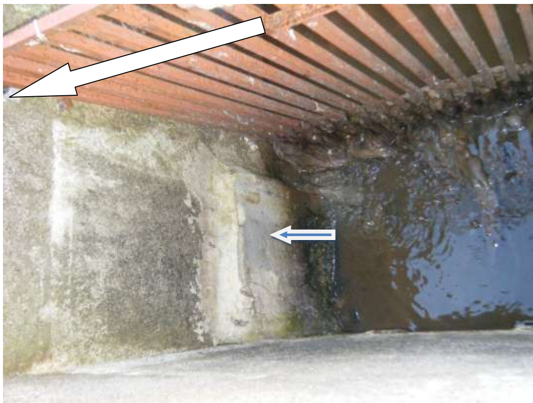
Photo N°1 : Si possible permettre le passage de part en part des murets de la tige de soutien de la grille statique afin qu'elle ne bascule pas sous le poids des déchets qui s'accumulent dessus. Flèche bleue, by-pass colmaté.
