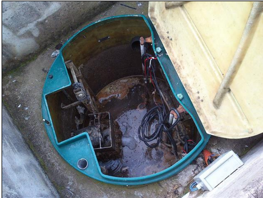
Photo 1 : Intérieur du poste de refoulement
