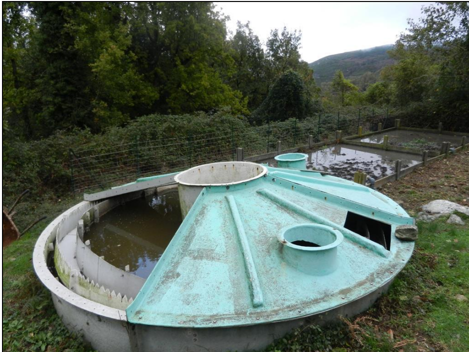
Photo 5 : Clarificateur de la station du stade
