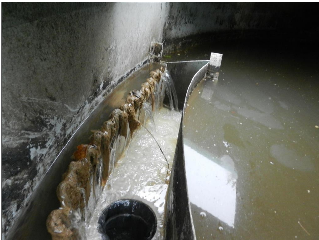
Photo 6 : Goulotte du clarificateur de la station du stade
