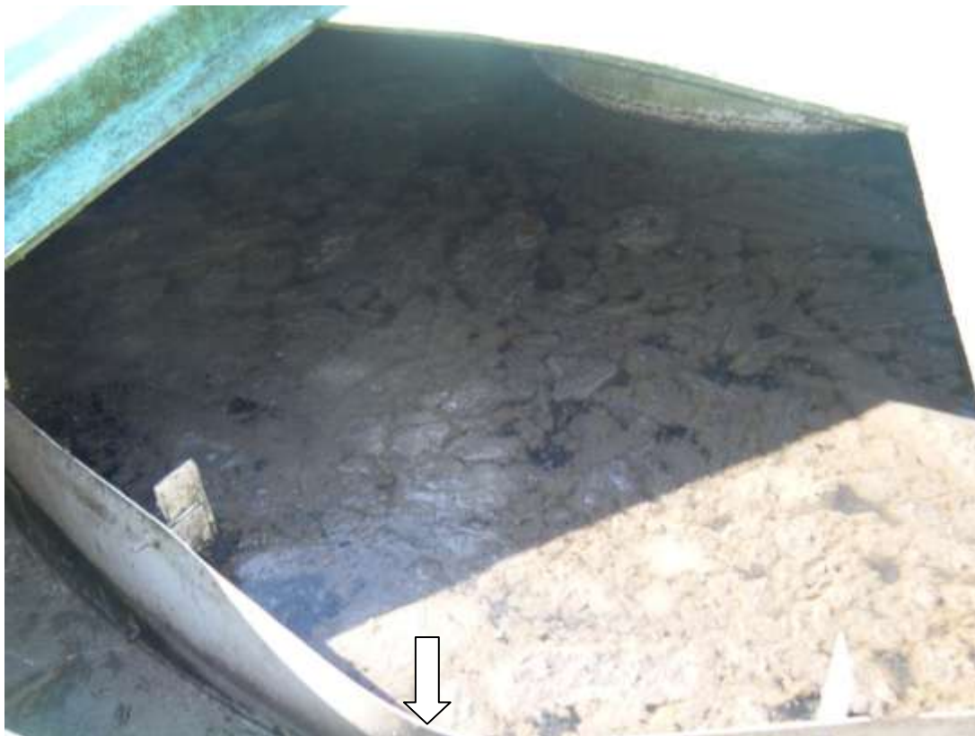
Photo N°3 : Remontées de boues en surface du clarificateur avant qu'elles ne soient coulées. A noter la goulotte d'évacuation de l'effluent traité qui s'est tordue sous l'effet de contraintes.
