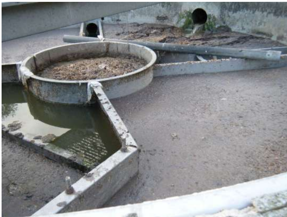
Photo N°5 : Remontées de boues et présence de boues et de graisses en surface sur le 1 er compartiment du décanteur digesteur.
