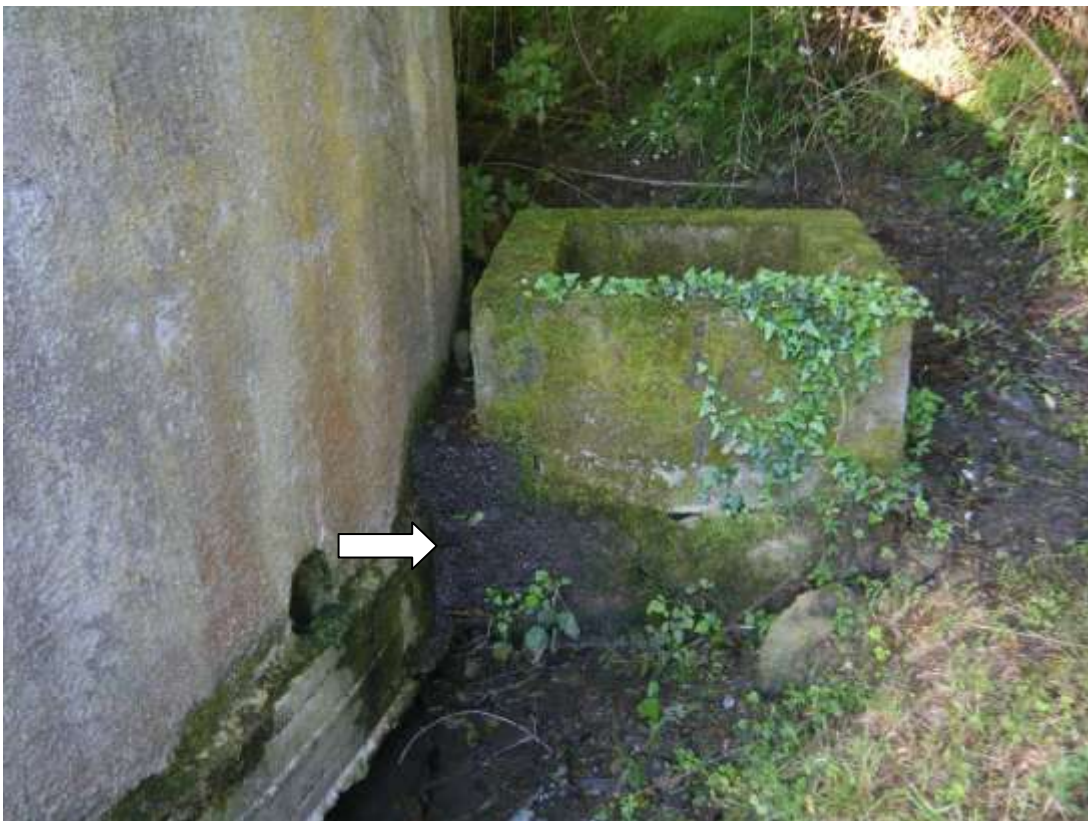
Photo N°6 : Fuite au niveau d'un angle du regard de reprise de l'effluent épuré du lit bactérien à colmater. A noter également la présence d'une source en amont qui s'écoule en direction du regard.
