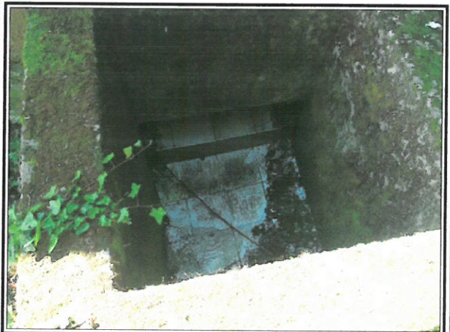
Illustration 4: Regard de sortie des effluents traités.
