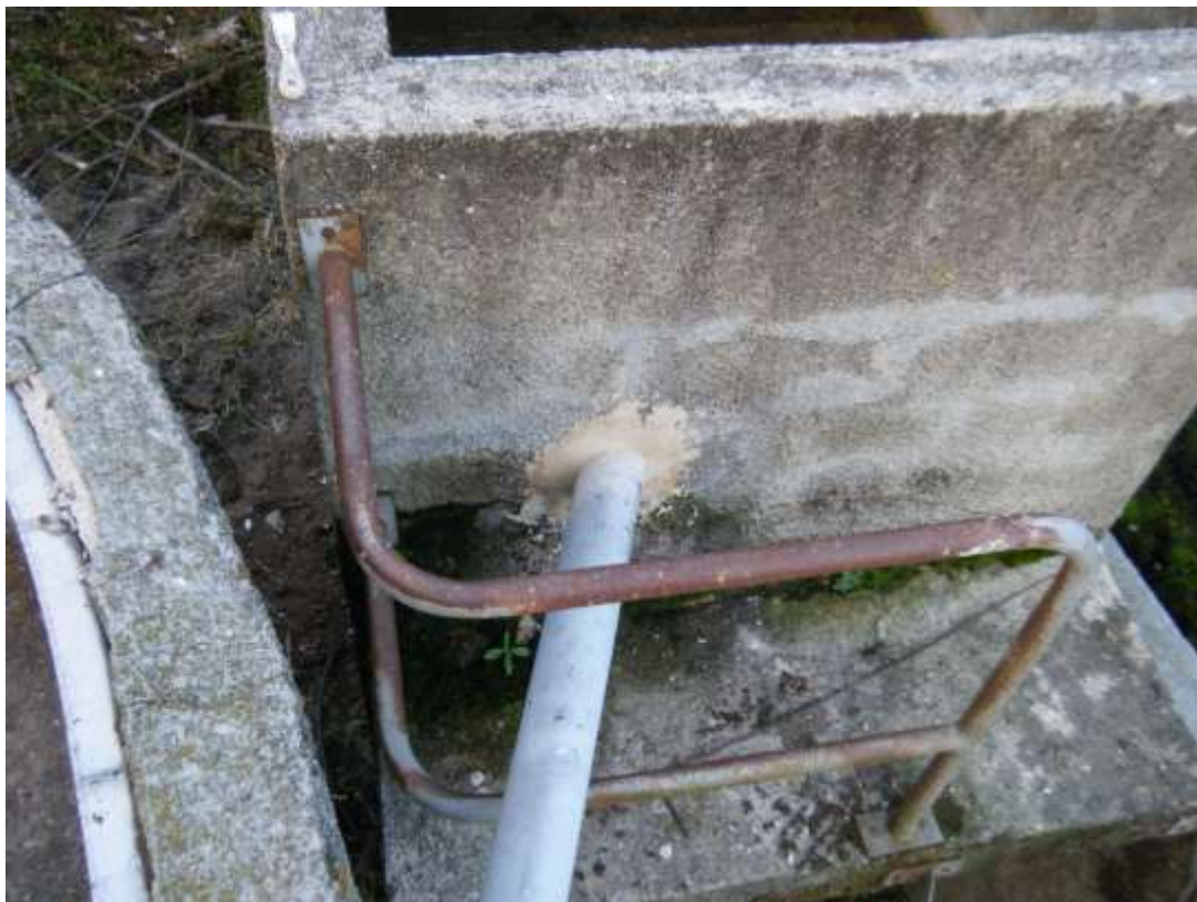
Photo N°9 : Fuite sous conduite d'amenée de l'effluent à l'ouvrage de chasse colmatée.
