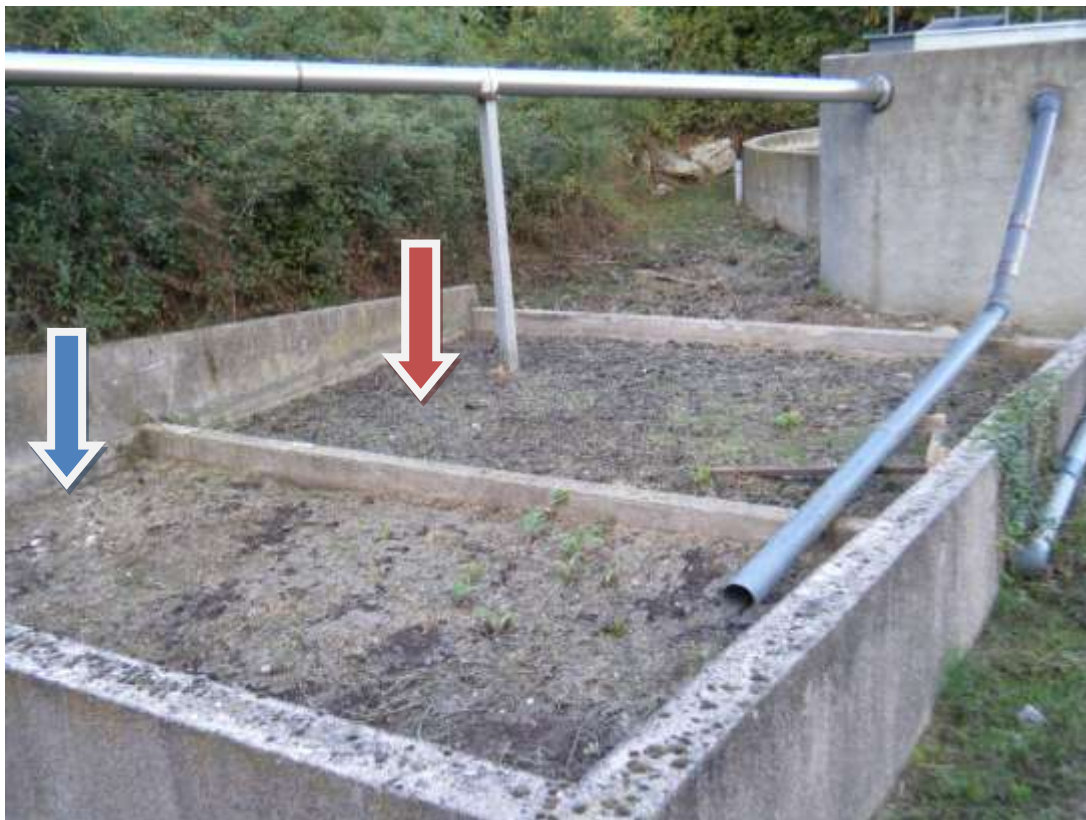
Photo N°8 : Lits de séchage des boues et des flottants (flèche bleue : lit destiné aux flottants et graisses ; flèche rouge : lit destiné aux boues de fond du décanteur digesteur).
