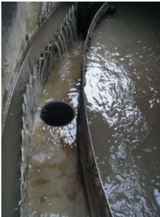
Photo N°3 : Goulotte de reprise du bassin d'aération (boues peu concentrées).
