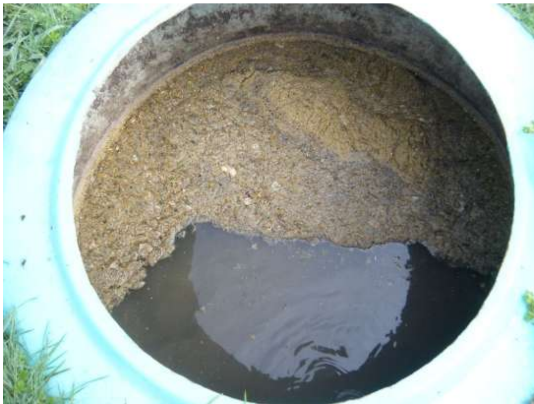
Photo N°4 : Dégazeur avec flottants à écrémer.
