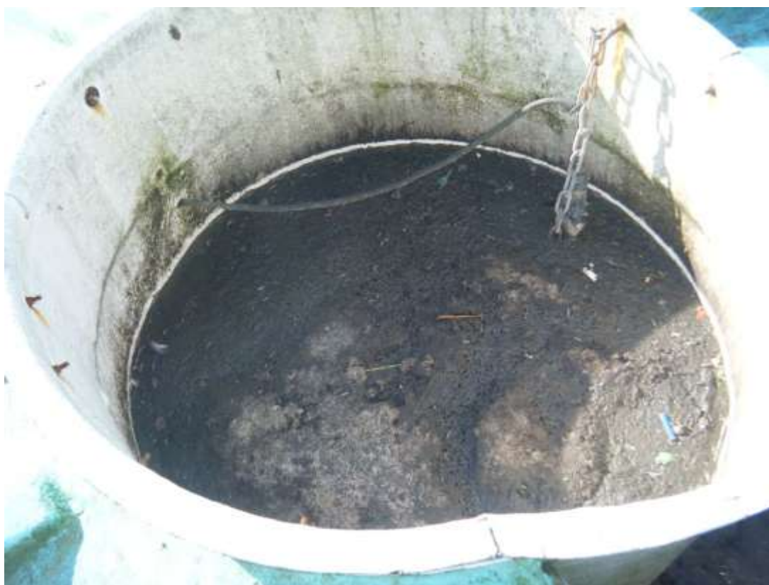
Photo N°4 : Remontées de boues dans la lumière du clarificateur avant d'être coulées.
