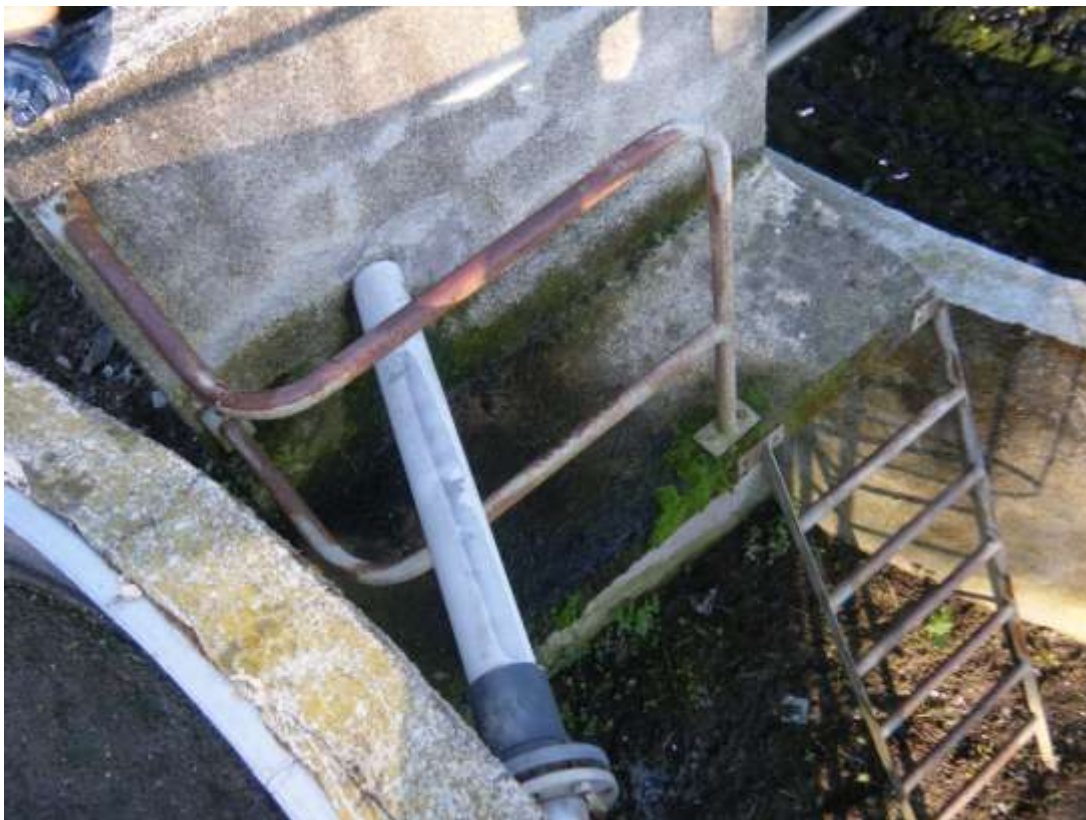
Photo N°4 : Fuites sur l'ouvrage de chasse à colmater.
