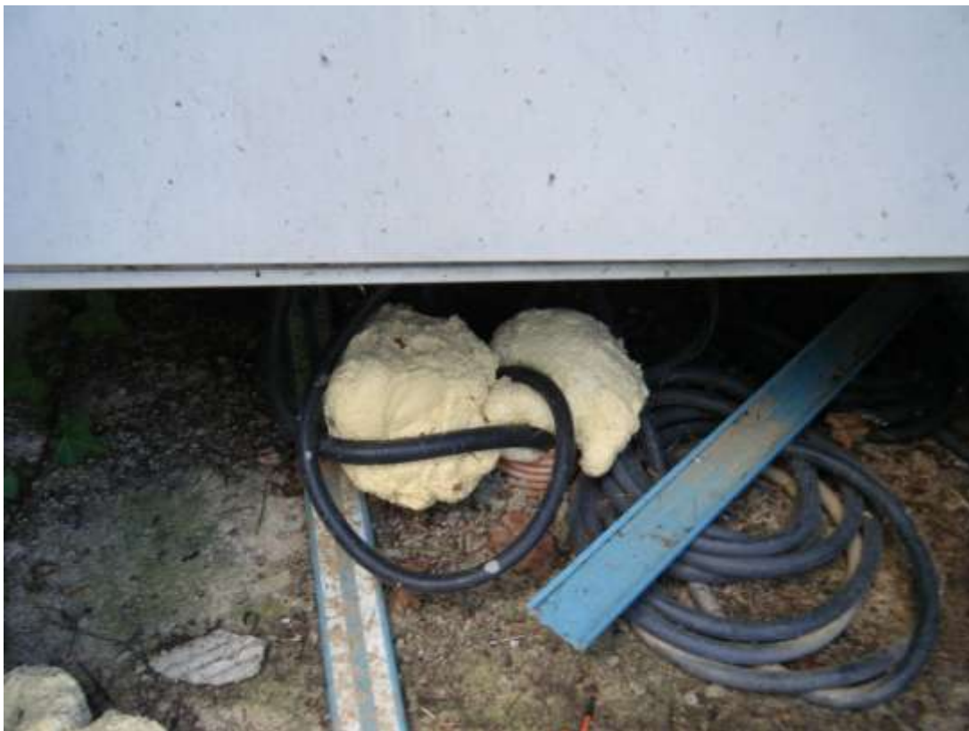
Photo N°2 : Mousse polyuréthane injectée dans les gaines électrique de l'armoire de commande des équipements électromécanique de la station d'épuration.
