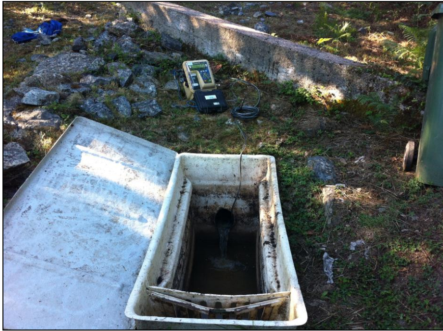
Photo 13 : Aperçu du débitmètre en entrée de station du stade
