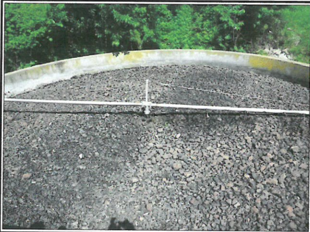
Illustration 3: Le sprinkler ne fonctionne pas. Il ne peut monter en charge en raison d'un dysfonctionnement de la chasse.
