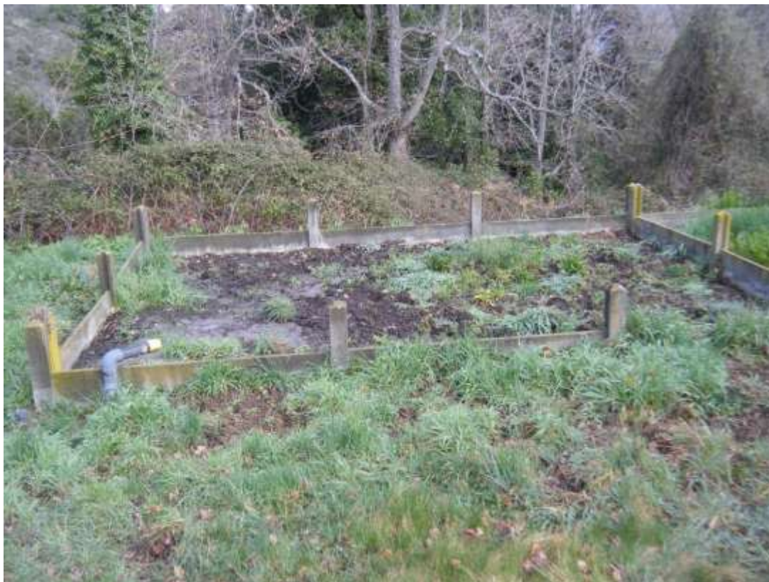
Photo N°9 : Soutirage de boues récent sur un lit (environ 1 m 3 ). Les anciennes boues sèches n'ont pas été évacuées au pied du lit (dans l'attente d'être envoyées vers un centre agréé). Clôture affaissée par la neige en 2010 à dégager du roncier et à retendre.
