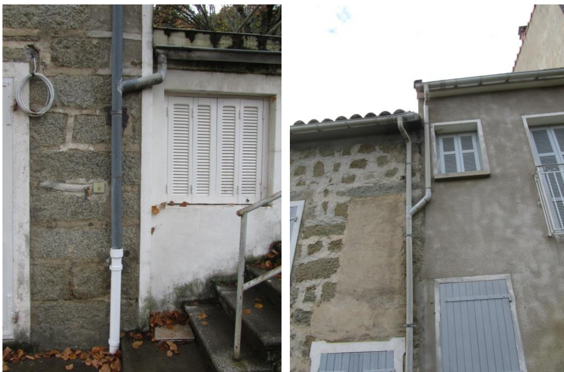
Figure 21 : Gouttières raccordées parcelles n° 244 et n° 557
