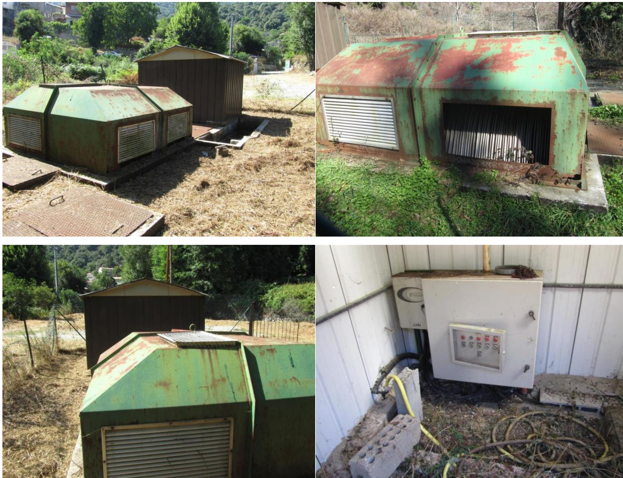
Figure 9 : Station de traitement - Local - Armoire électrique (Juillet 2012 et Mars 2013)
