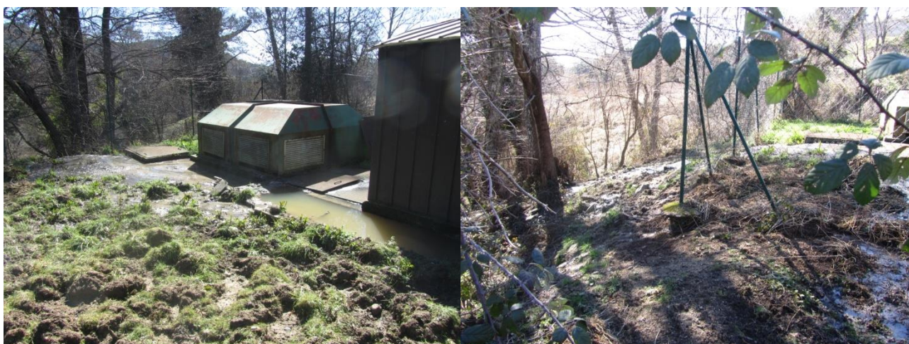
Figure 14 : Station de traitement et rejet (Mars 2013)
