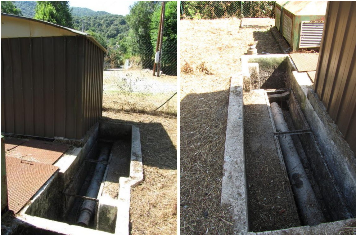
Figure 10 : Canal d'arrivée des effluents (Juillet 2012)
