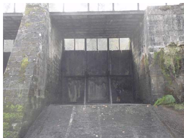
Photo n° 4 : Vanne de décharge à remplacer par un clapet
