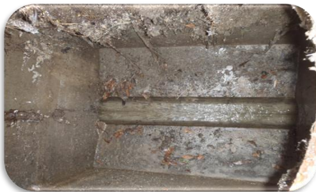
Photo du déversoir en amont de la STEP
