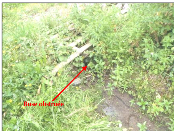
Buse obstruée - Hameau « Chez Dametaz »
