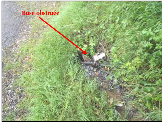
Buse obstruée - Hameau « La Biolaz »
