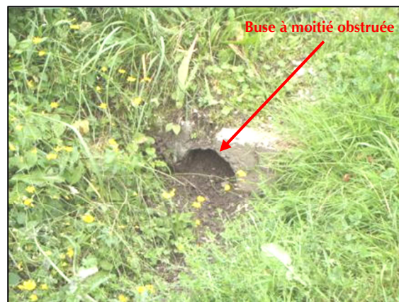
Buse obstruée - Hameau « Chez Dametaz »
