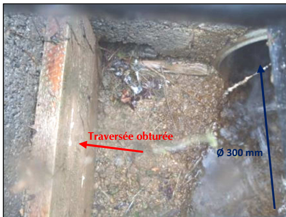
Traversée obturée au droit de la RD 20, en amont du hameau « Romblaz »
