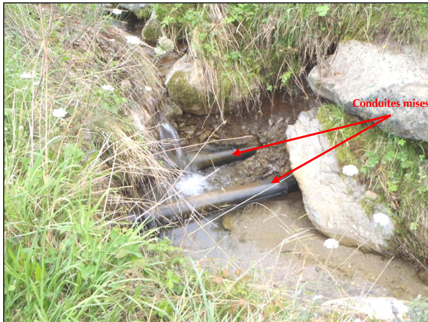
Conduites d'eau potable mises à nue
