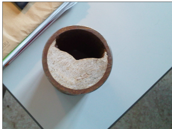
Photographie n°1: Dépôt « calcaire » constaté dans la canalisation de liaison entre les 2 sources de La Cote
