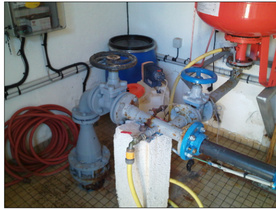
Pompe d'injection du chlore
