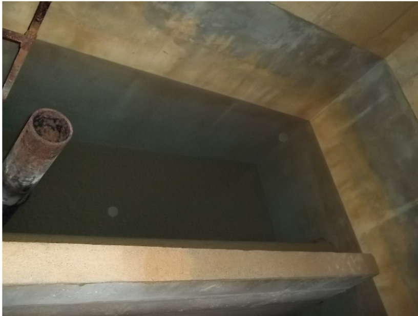
Cuve tampon d'injection du chlore
