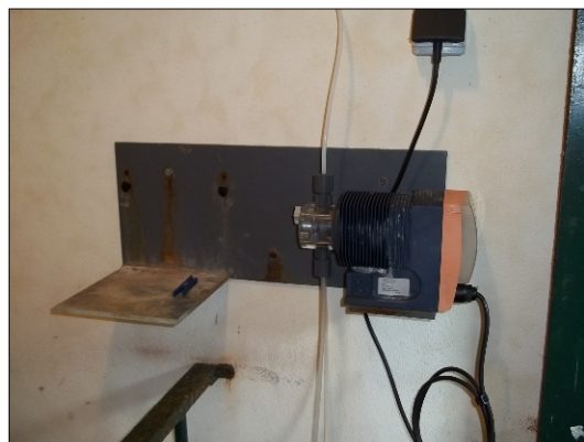
Pompe d'injection du chlore
