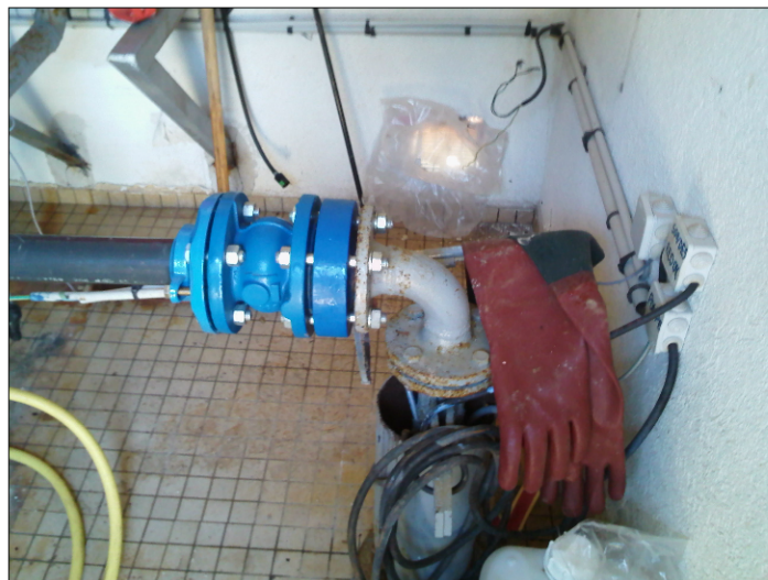
Vue intérieur du local – sortie du puits de forage
