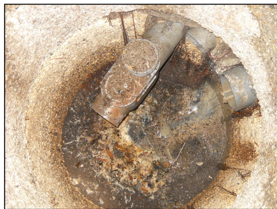
Photo 2 : branchement mal renformi avec introduction de racines (MARC. 0215)
