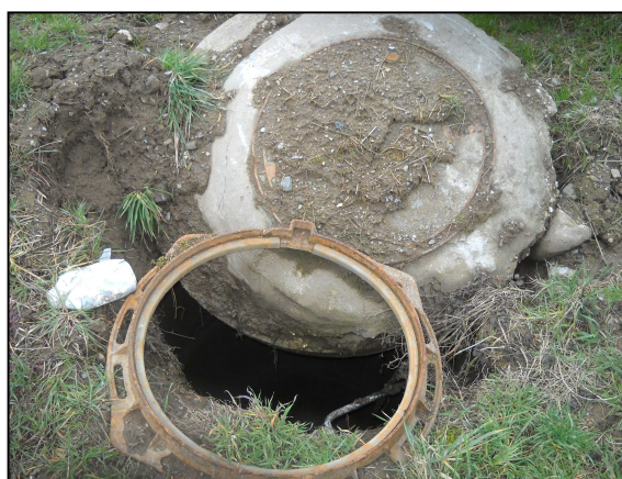
Photo 3 : cadre descellé et désaxé (CONT. 0436)
