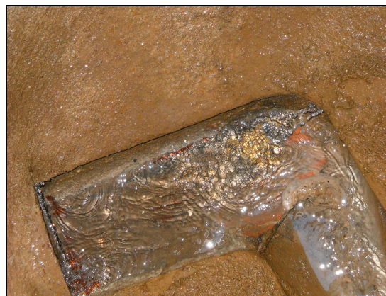
Photo 15 : infiltration (pissette) d'eaux claires (FAUC. 0060)
