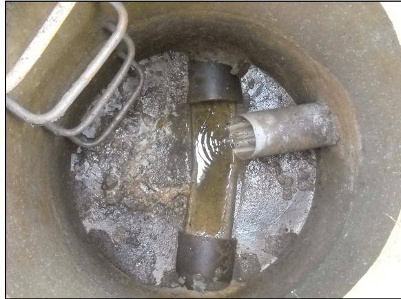
Photo 11 : eau stagnante, écoulement lent (MARC. 0005)
