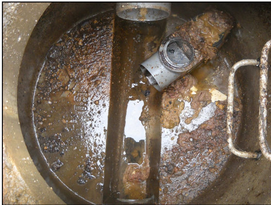
Photo 1 : siphon bouché (MARC. 0155)
