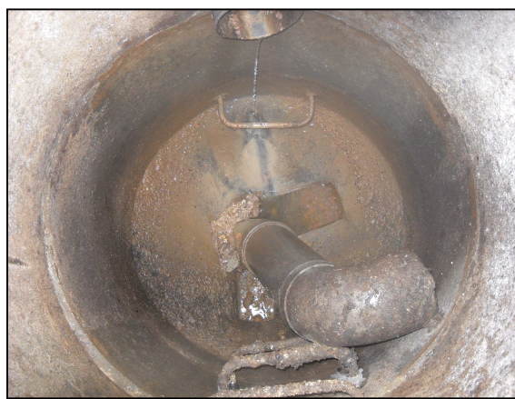
Photo 9 : obstacle à l'écoulement entraînant la formation de dépôts (CONT. 0298)
