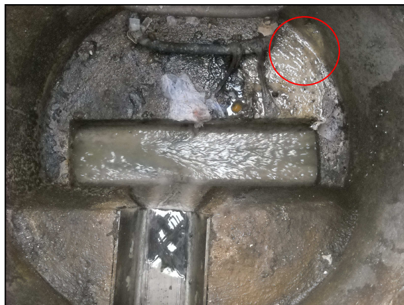
Photo 6 : perforation à l'origine d'infiltration d'eaux claires parasites (FILL. 0008)
