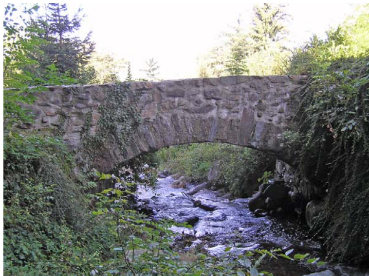
Pont en Pierre au hameau de la Gorge sur le ruisseau de Prémol Photo d.monin/onf
