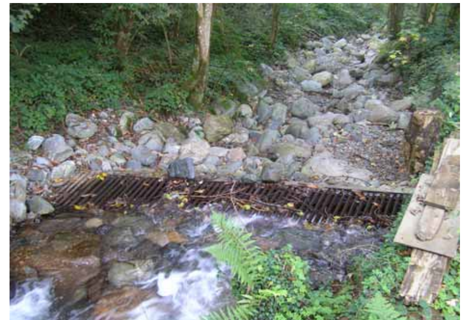
Ouvrage n° 7 - Prise d'eau : le débit réservé n'est pas respecté, le ruisseau est à sec (photo dmonin/onf)
