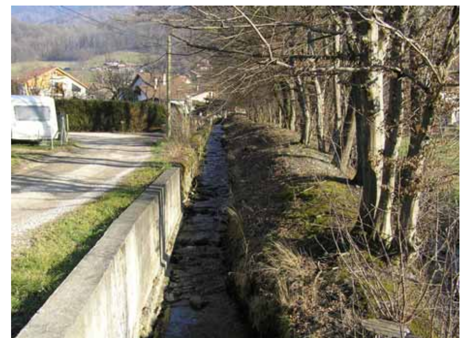
Ouvrage n° 9, mur de soutènement sur la rive droite du ruisseau. La végétation est bien entretenue en rive droite, le lit mineur chenalisé est sous-dimensionné en cas de crue importante. (photo dmonin/onf)
