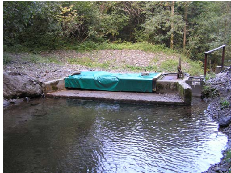
Prise d'eau destinée à la production d'électricité, sur le ruisseau de Prémol Photo d.monin/onf
