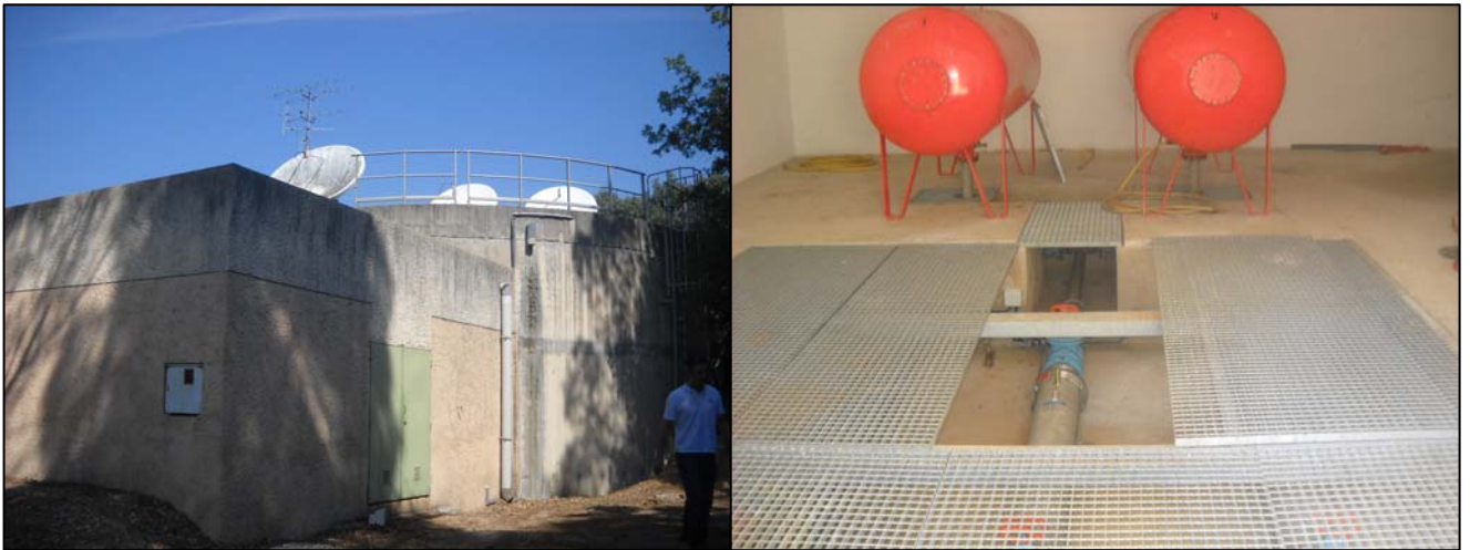
Figure 9 : Le réservoir de Roudaï et son surpresseur
