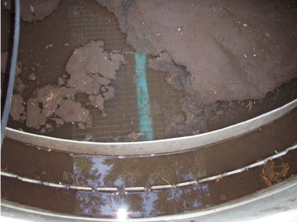
Départs de boues de la station lors de la seconde visite
