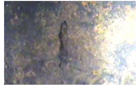
Perforation située a 3.7 m
