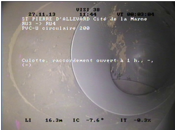
Photo: 0000025.JPG 16,3m, Culotte, raccordement ouvert à 12 h., -, (-)
