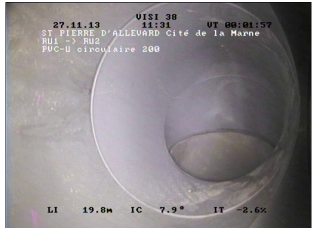
Photo: 0000008.JPG 19,84m, Culotte, raccordement ouvert à 12 h., -, (-)
