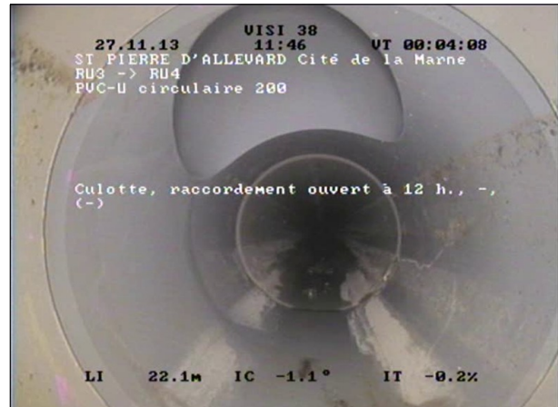
Photo: 0000026.JPG 22,42m, Culotte, raccordement ouvert à 12 h., -, (-)
