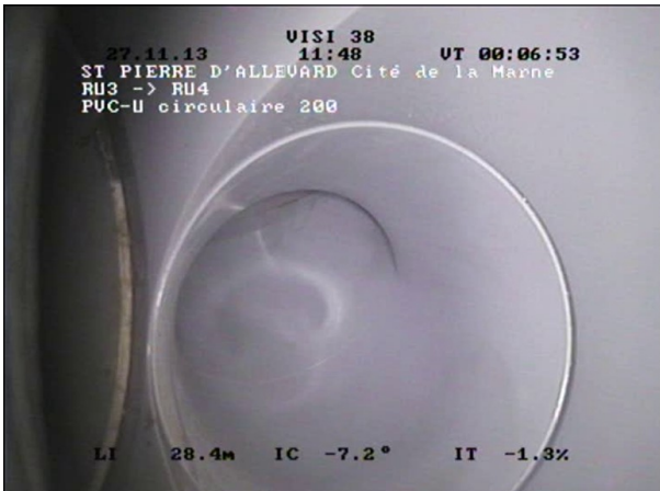
Photo: 0000029.JPG 28,47m, Culotte, raccordement ouvert à 11 h., -, (-)
