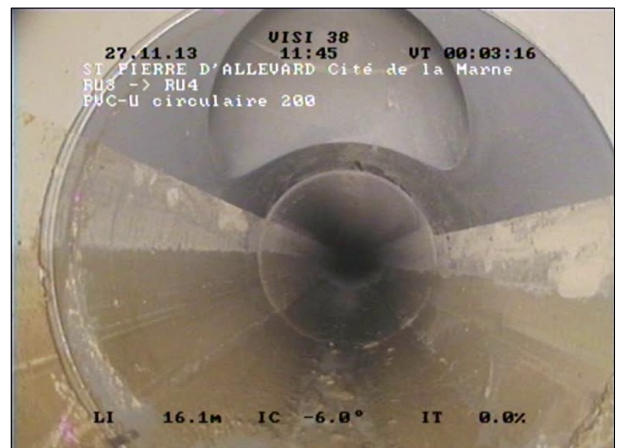
Photo: 0000024.JPG 16,3m, Culotte, raccordement ouvert à 12 h., -, (-)
