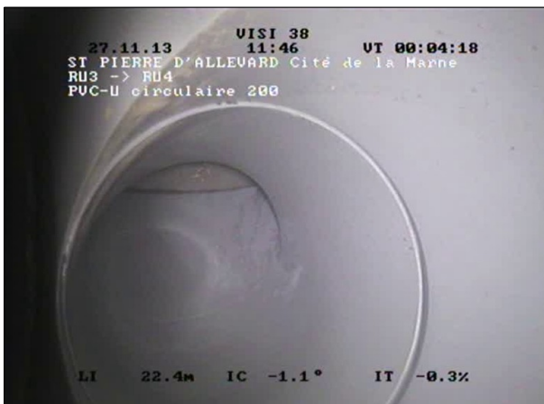
Photo: 0000027.JPG 22,42m, Culotte, raccordement ouvert à 12 h., -, (-)
