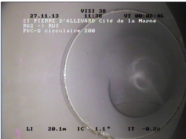
Photo: 0000015.JPG 20,19m, Culotte, raccordement ouvert à 12 h., -, (-)
