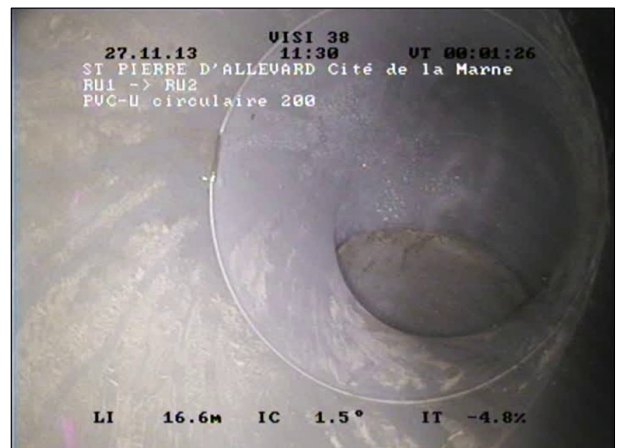
Photo: 0000006.JPG 16,61m, Culotte, raccordement ouvert à 1 h., -, (-)
