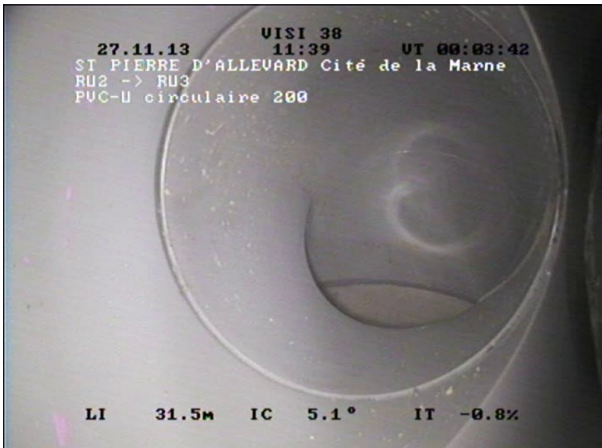
Photo: 0000017.JPG 31,5m, Culotte, raccordement ouvert à 12 h., -, (-)
