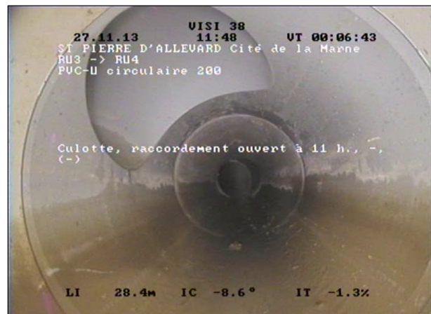
Photo: 0000028.JPG 28,47m, Culotte, raccordement ouvert à 11 h., -, (-)
