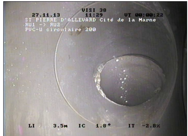
Photo: 0000004.JPG 3,52m, Culotte, raccordement ouvert à 1 h., -, (-)
