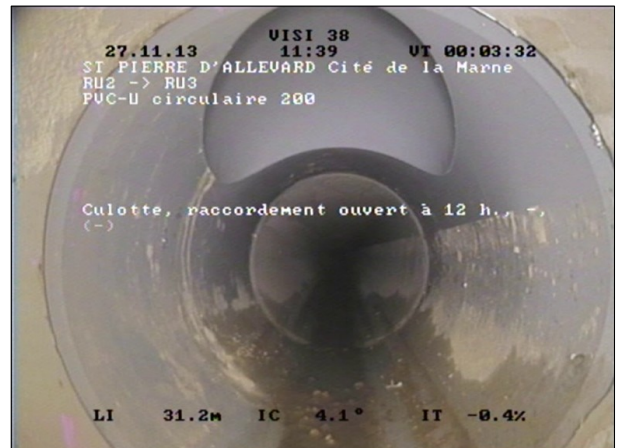
Photo: 0000016.JPG 31,5m, Culotte, raccordement ouvert à 12 h., -, (-)
