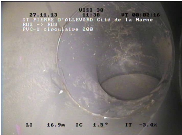
Photo: 0000013.JPG 16,95m, Culotte, raccordement ouvert à 12 h., -, (-)
