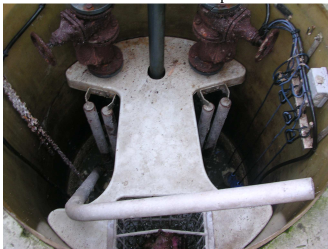
Intérieur de la cuve du poste :
