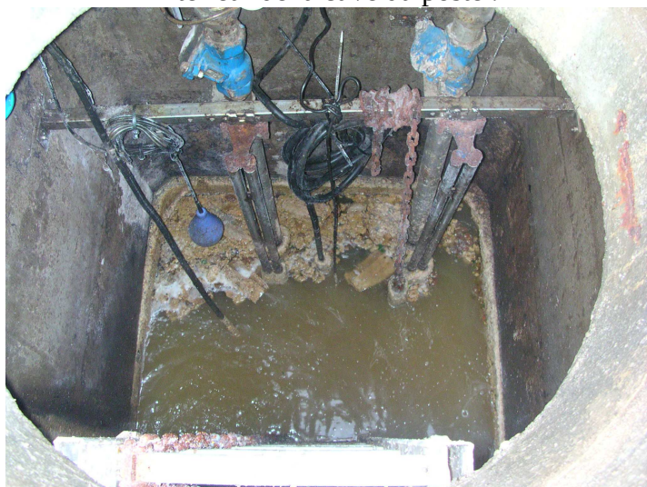
Intérieur de la cuve du poste :
