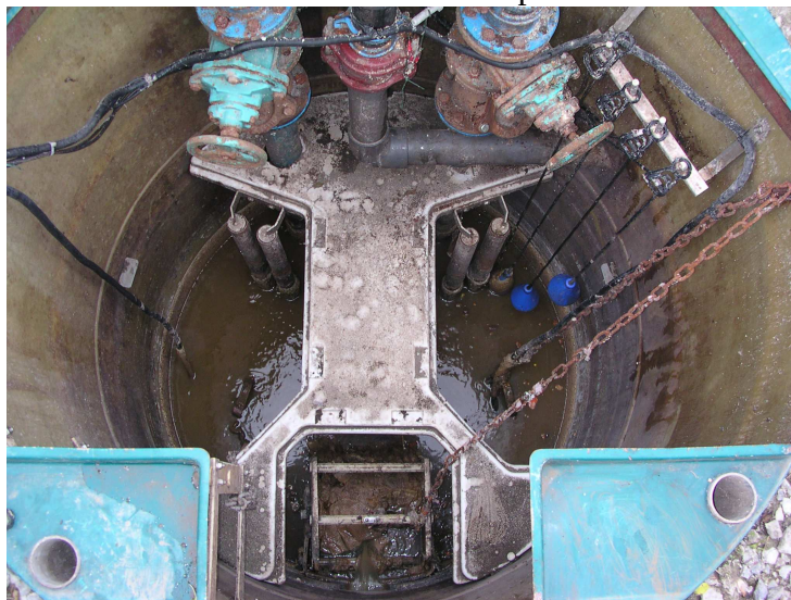
Intérieur de la cuve du poste :
