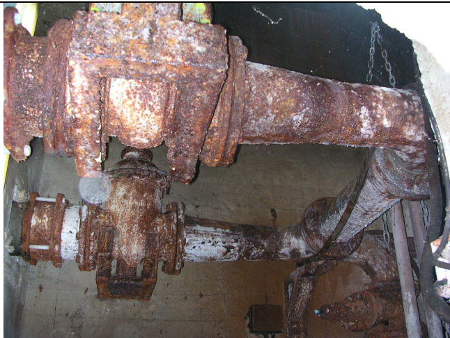
Canalisations de refoulement :
