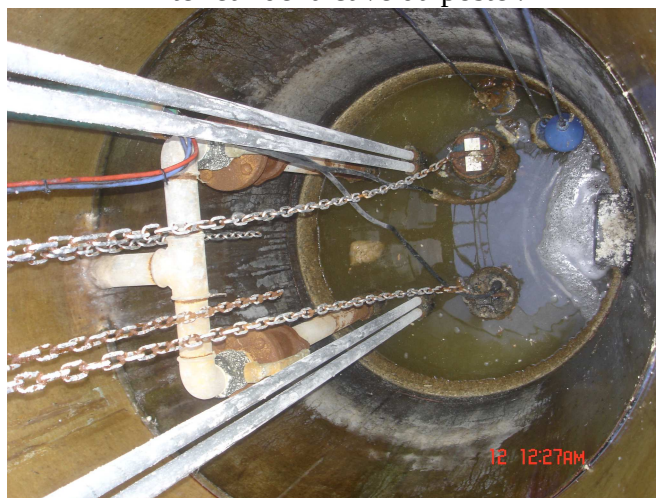
Intérieur de la cuve du poste :
