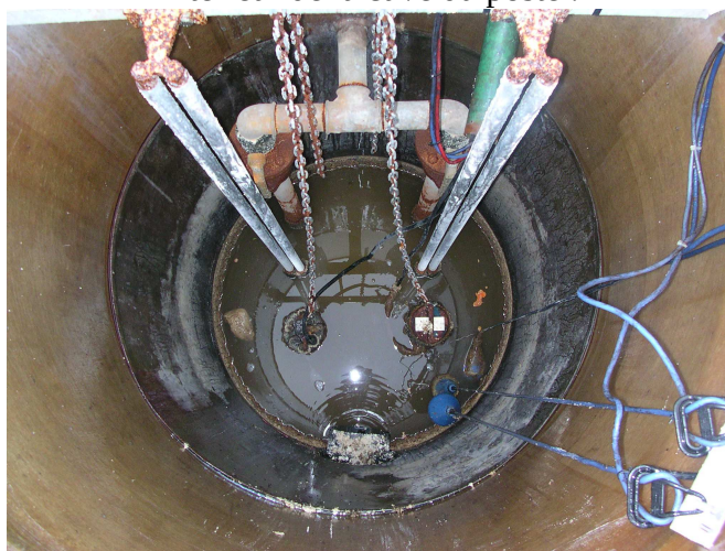
Intérieur de la cuve du poste :
