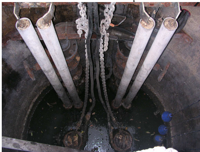
Intérieur de la cuve du poste :
