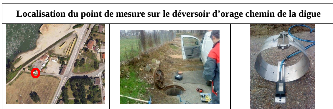
Figure 2-4 : Point de mesure sur le déversoir d'orage – chemin de la Digue
